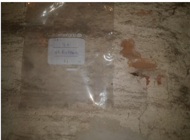
Kuva 19. Materiaalinäyte 20. Kellari. Seinä. Rappaus.
