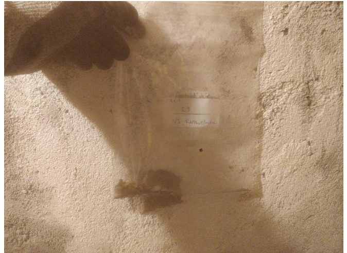
Kuva 22. Materiaalinäyte 23. Kellari. Seinä. Rappaus.
