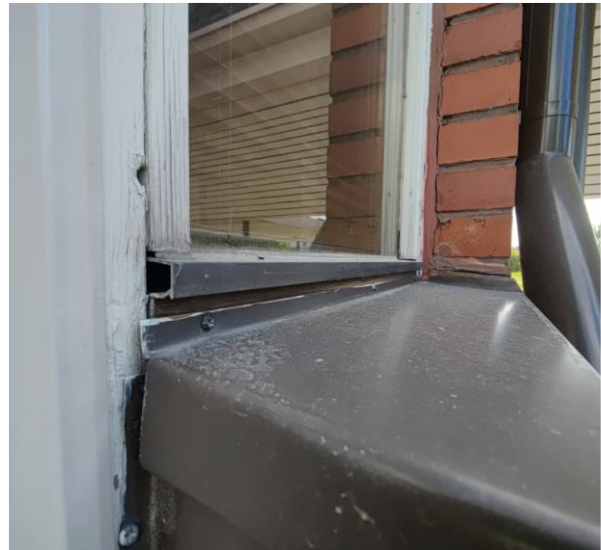
Kuva 49 Ikkunan pellityksen ja puitteen välinen liitos on monin paikoin epätiivis.
