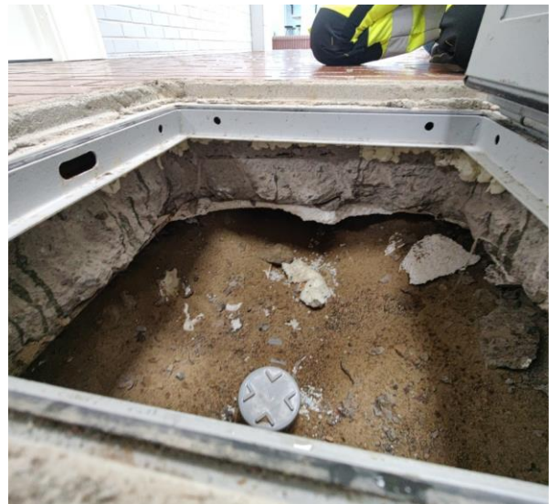
Kuva 31 Kuva itäsiiven käytävällä olevasta kaasutiiviistä tarkastusluukusta. Täyttömaa on hienojakoista hiekkaa. Täyttöaineskerros on painunut.
