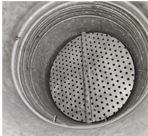
Kuva 84 Alkuperäisen tuloilmahajotimen säätöpelti.
