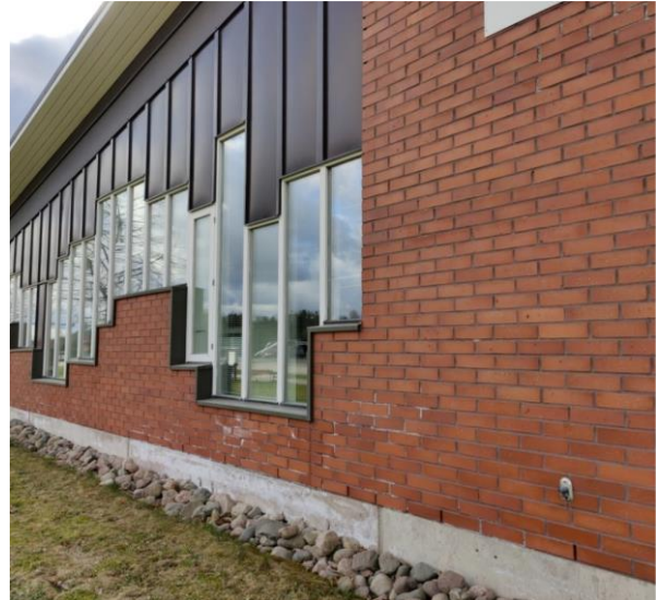
Kuva 47 Kuva ruokasalin ikkunoista. Ikkunoiden sadevedenpitävyydessä havaittiin puutteita.
