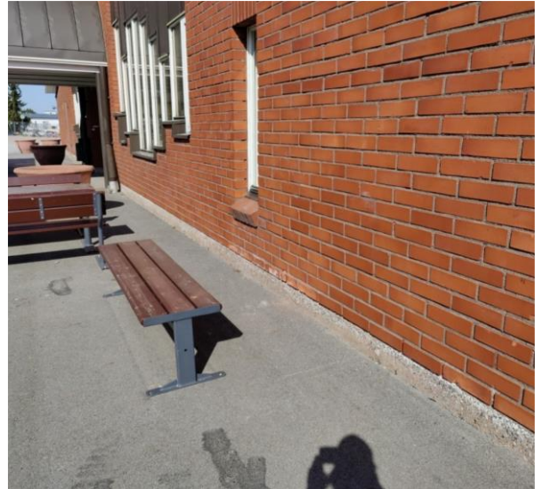
Kuva 6 Kuva rakennuksen eteläisivustalta itäsiiven sisäänkäynnin edustalta. Piha-alue on asfaltoitu. Sokkelin maanpinnan yläpuolinen korkeus on kohdassa matala.
