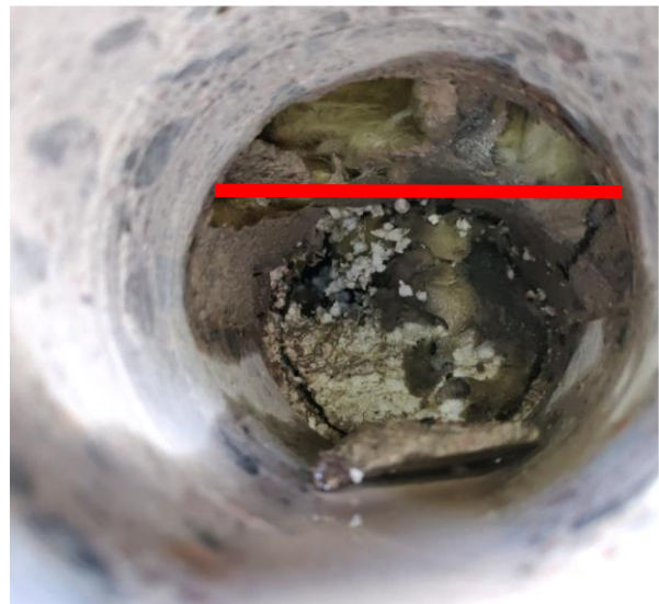
Kuva 11 Sokkelin yläosan taustalla on n. 150mm matkalla mineraalivillaa. Sokkelin betonirakenne on ohuempi yläosassa (rajapinta merkitty kuvaan punaisella). Perusmuurin ja sokkelin välinen eriste on EPS-eristettä.
