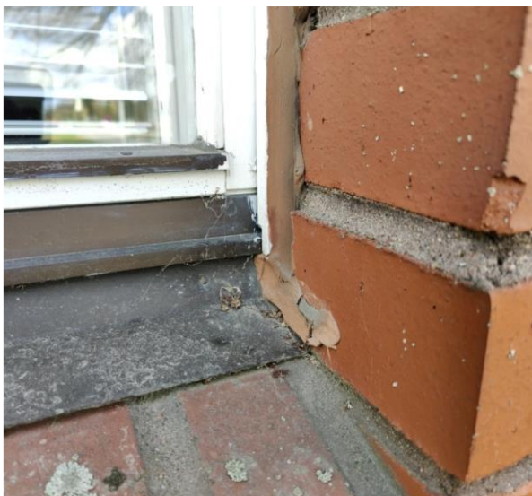
Kuva 44 Ikkunoiden ja julkisivun väliset saumat ovat ikääntyneitä.
