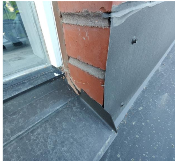
Kuva 57 Ikkunan ja vesikaton välisen liittymän pellitys ei ole sadevesitiivis.
