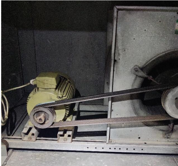
Kuva 70 Alkuperäinen hihnavetoinen tuloilmapuhallin TK-1
