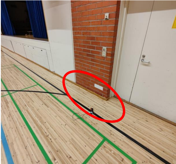
Kuva 24 Liikuntasalin edustalla olevassa käytävässä havaittiin mikrobiperäistä hajua. Hajua havaittiin voimakkaana salin sisäänkäynnin vieressä jalkalistan taustalla.
