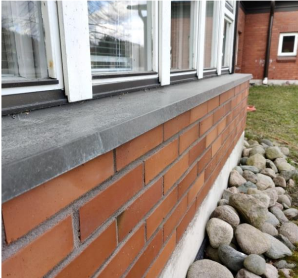
Kuva 46 Pellityksien kallistukset ovat puutteellisia.
