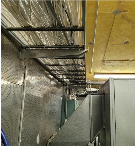
Kuva 91 Kaapelihyllyä ilmanvaihdon konehuoneessa.
