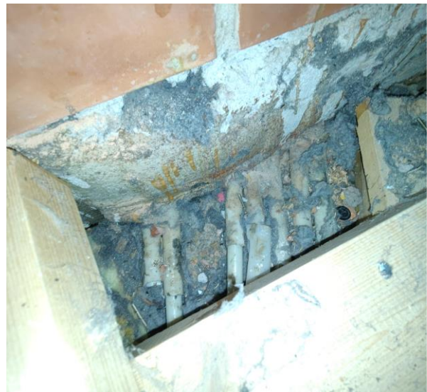
Kuva 27 Alapohjarakenteessa on tiivistämättömiä sähköläpivientejä, joiden kautta voi kulkeutua ilmavirtausten mukana mikrobiperäistä hajua tiloihin.
