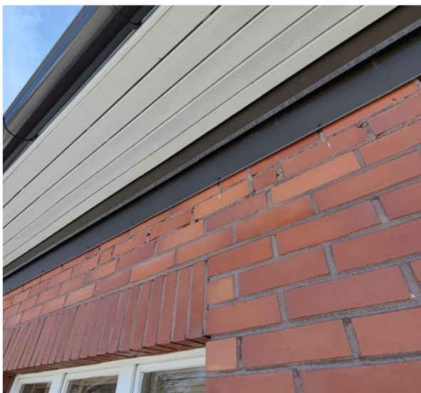
Kuva 38 Tiilijulkisivujen yläosassa olevat laastisaumat ovat heikompikuntoisia. Vesikattokorjauksen yhteydessä räystään korkeutta on nostettu.
