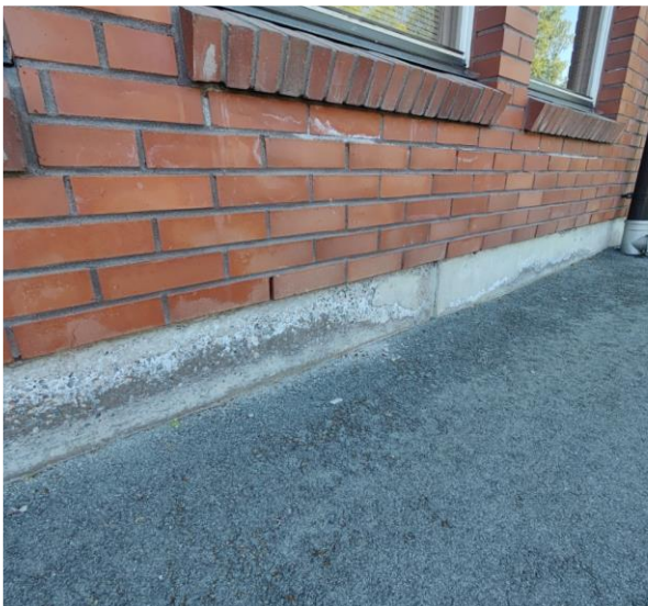
Kuva 14 Sokkelin pintabetoni on rapautunut rakennuksen eteläisivustalla pääsisäänkäynnin vieressä.
