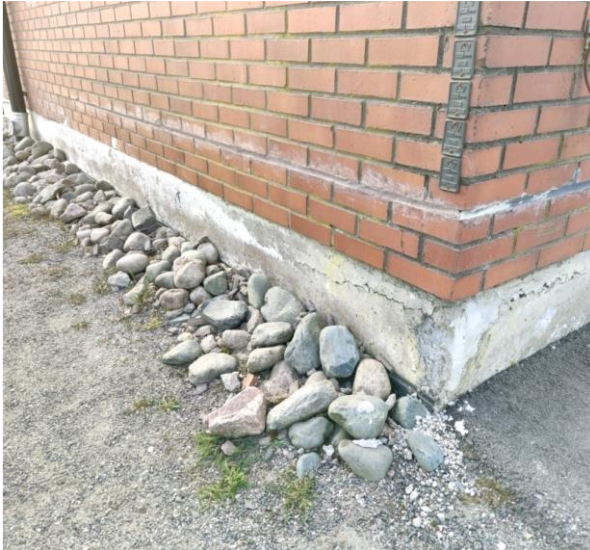
Kuva 12 Länsisivustan ruokalan edustalla olevan katoksen sokkelirakenteet ovat heikkokuntoisia.
