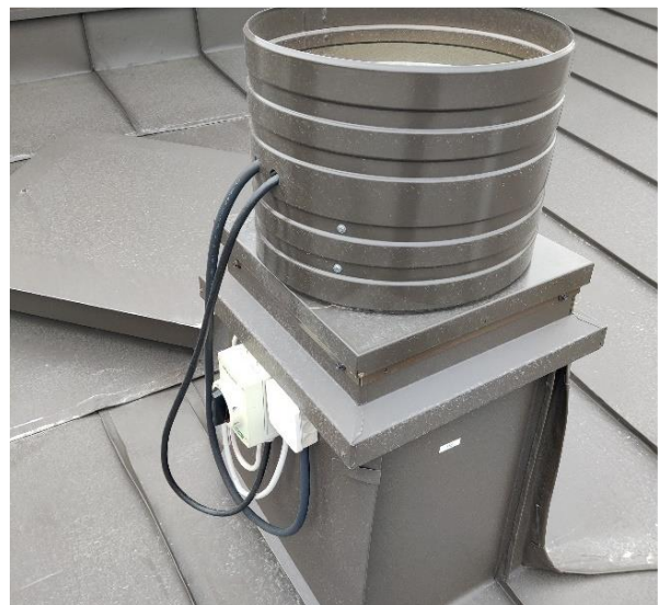
Kuva 73 Vuonna 2019 uusittu huippumuri vesikatolla.
