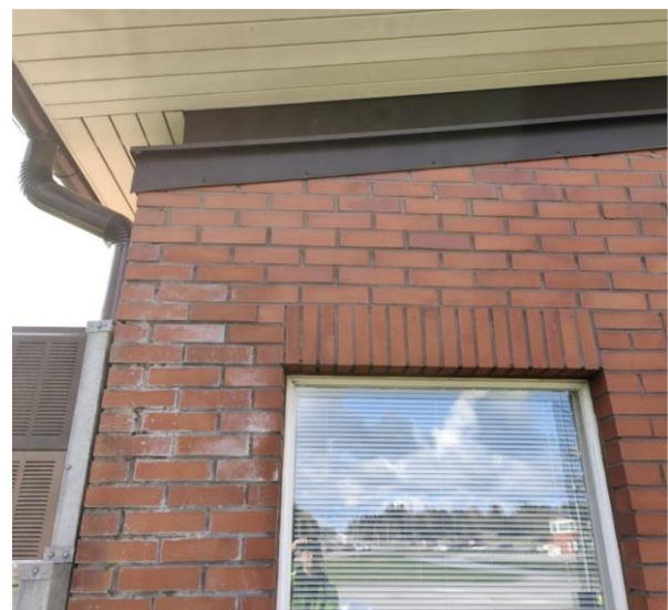
Kuva 35 Koilliskulmauksessa havaittiin runsaasti härmää ja merkkejä kosteusrasituksesta tiilijulkisivussa.
