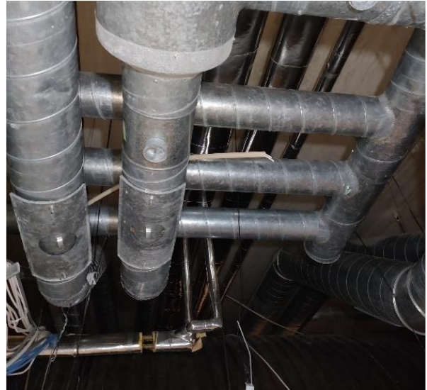
Kuva 77 Alakaton yläpuolella kulkeutuvia ilmanvaihtokanavia.
