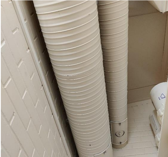
Kuva 76 Tarkastusluukulla varustettuja ilmanvaihtokanavia
