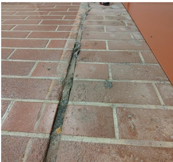
Kuva 22 Liikuntasauvan massaukset olivat paikoin irronneet reuna-alueiltaan ja saumakohdassa oli tiililaattapintojen halkeilua.
