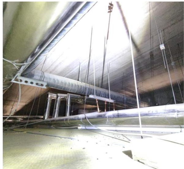
Kuva 67 alakattolevyjen päällä havaittiin runsaasti jyräjoiden jätöksiä. Yläpohjan ontelolaattapinta on tarkastelujen perusteella siisti.
