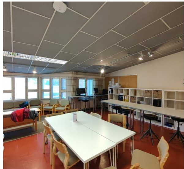
Kuva 63 Yleiskuva opettajanhuoneesta. Lattiapäällysteenä länsisiivessä on huonetiloissa pääosin alkuperäinen punertava muovimatto. Alakattolevyt ovat alkuperäisiä kangaspäällysteisiä villalevyjä. Levyt ovat heikkokuntoisia.
