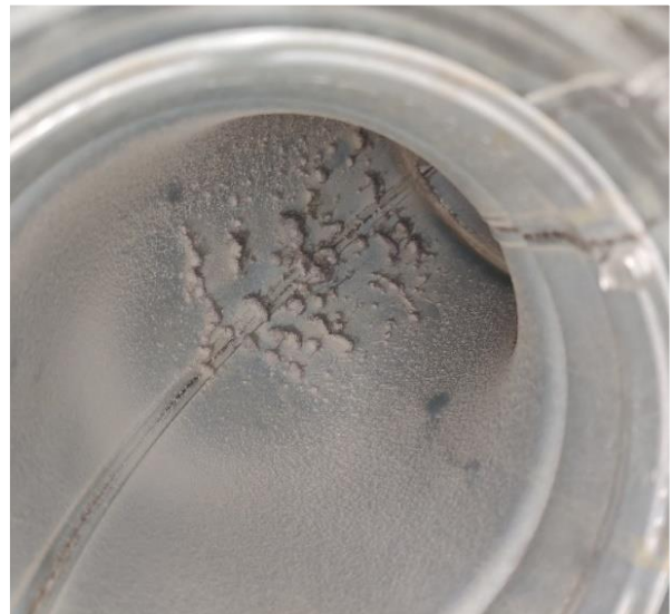
Kuva 79 Ilmanvaihtokanavissa havaittiin paikoittain paksua pölykertymää.
