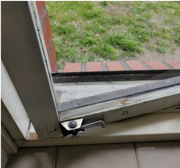
Kuva 48 Ikkunoiden puukarmit ovat paikoin heikkokuntoisia. Toiminnassa todettiin joitain puutteita.
