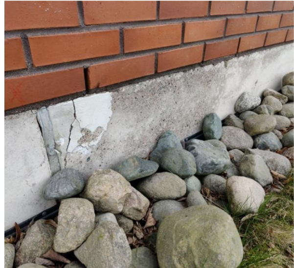
Kuva 9 Sokkelin elastiset saumaukset ovat irtailleet reuna-alueiltaan ja massan tiiveys on paikoin heikkoa. Sokkelin pintaosissa on halkeilua.
