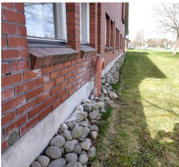
Kuva 34 Yleiskuva rakennuksen pohjoissivustalta. Julkisivussa havaittiin runsaasti merkkejä kosteusrasituksesta.
