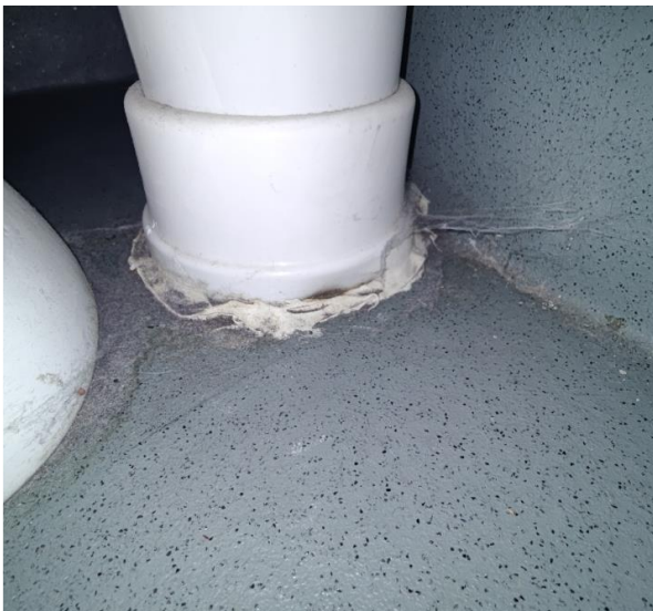
Kuva 62 WC-pytyjen läpivientien tiivistyksissä oli paikoin puutteita. Wc-tilojen lattiapäällysteiden alapuolella todettiin kohonnutta kosteutta.
