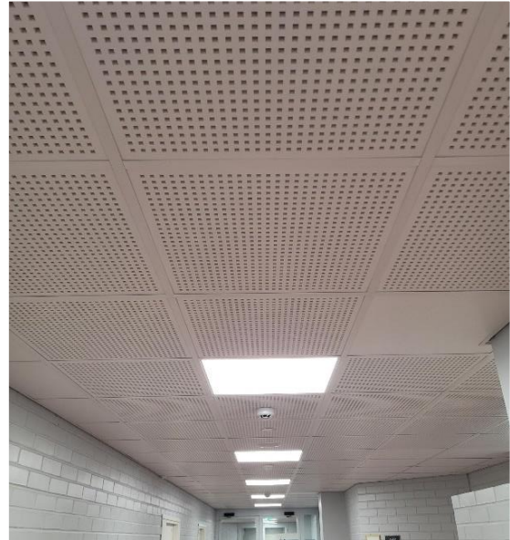
Kuva 103 Aulan uusittua LED-valaistusta.
