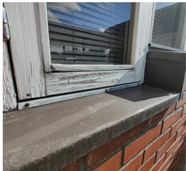
Kuva 45 Pellitysten kallistuksissa havaittiin puutteita.
