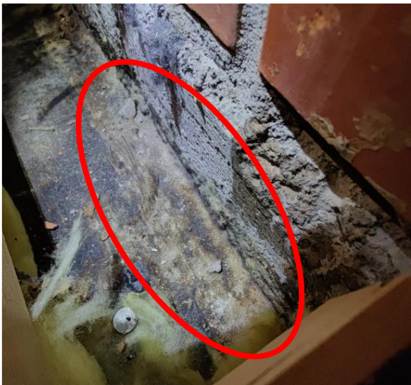
Kuva 26 Rakenneavauksen RA60 kohdalla betonilaatan ja betonisen perusmuurin rajapinnassa havaittiin näkyvää mikrobikasvustoa ja merkkejä kosteusrasituksesta.
