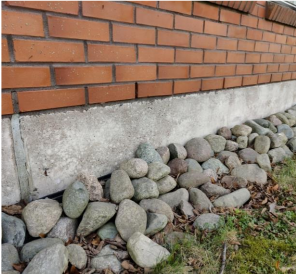
Kuva 8 Sokkeli rakennuksen pohjoissivustalla. Betonin pintaosat kuluneita ja betonipinta on monin paikoin lohkeillut.
