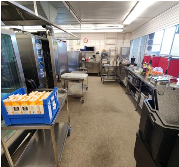
Kuva 64 Keittiössä lattian pinnoitteena on akryylibetoni / epoksimassa. Lattiapinnan kallistuksissa todettiin paikallisia puutteita.
