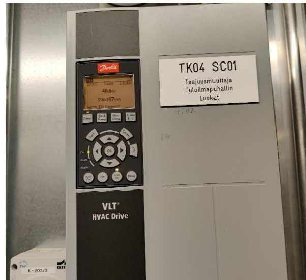
Kuva 69 TK/PK-4:n puhaltimia ohjataan taajuusmuuntajilla.
