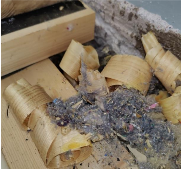
Kuva 28 Liikuntasalin puukoolatun alapohjan eristekerroksena on paikoin kutterilastua. Eriste oli voimakkaasti likaantunutta reuna-alueilta.
