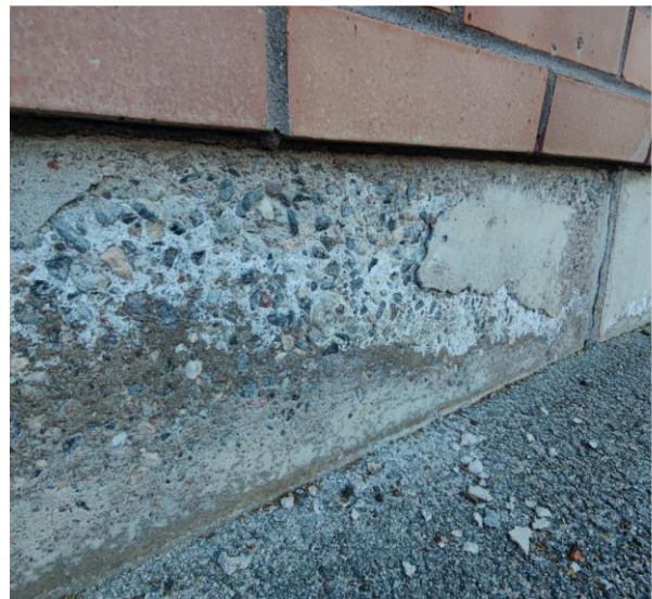
Kuva 15 Sokkelin pintabetonin rapautumista.
