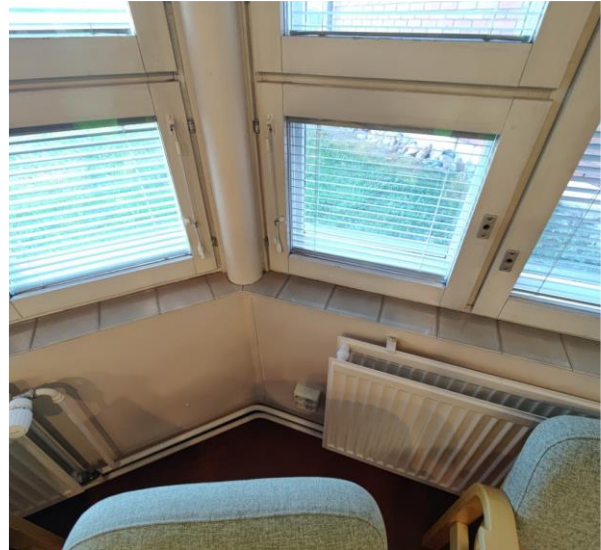
Kuva 41 Opettajanhuoneen kohdalla erkkerirakenteen sisäpinnassa havaittiin halkeilua ja merkittäviä ilmavuuotoja sisätilojen suuntaan.
