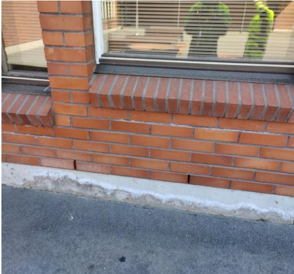
Kuva 16 Eteläsivustalla sokkelin alaoissa havaittiin merkkejä kosteusrasituksesta. Sokkelin korkeus on paikoin erittäin matala ja ulkoseinäeristeenä oleva mineraalivilla on lähellä maanpinnan tasoa.
