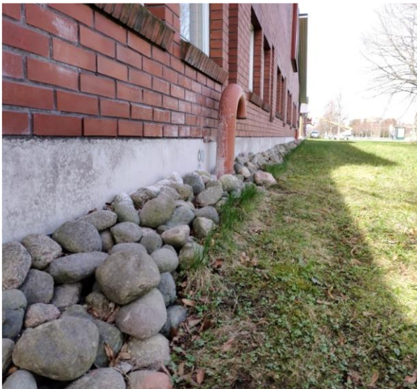
Kuva 3 Kuva rakennuksen pohjoissivustalta Voivalantien vastaiselta osuudelta. Rakennuksen vierusta on kivetetty salaojien peruskorjauksen yhteydessä. Ruohopintainen maanpinta kallistaa loivasti pois päin rakennukselta.
