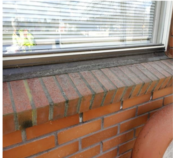
Kuva 43 Suuri osa ikkunapenkeistä on toteutettu tiilimuurauksilla. Ikkunapenkeillä havaittiin runsaasti merkkejä kosteusrasituksesta.
