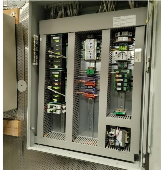
Kuva 86 Valvonta-alakeskukset on uusittu vuonna 2021.
