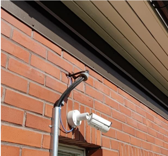
Kuva 40 Julkisivuilla havaittiin tiivistämättömiä tai heikosti tiivistettyjä sähkö- ja putkiläpivientejä.
