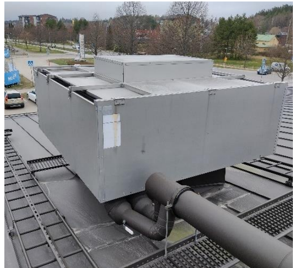
Kuva 75 Keittiön rasvahuuvaan yhdistetty LTO-huippumuri. (Valmistusvuosi 2007)
