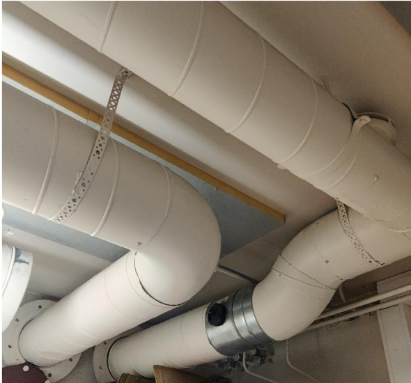
Kuva 80 Väestönsuojan ilmanvaihtokanavia on kannakoitu käyttäen reikänauhaa.
