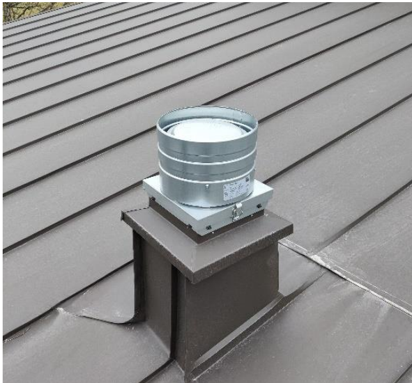
Kuva 74 Vetokaapin uusittu huippumuri. (Valmistusvuosi 2022)
