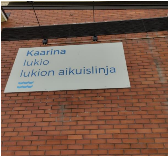
Kuva 36 Kuva pohjoisjulkisivulta. Seinässä on merkkejä kosteusrasituksesta.
