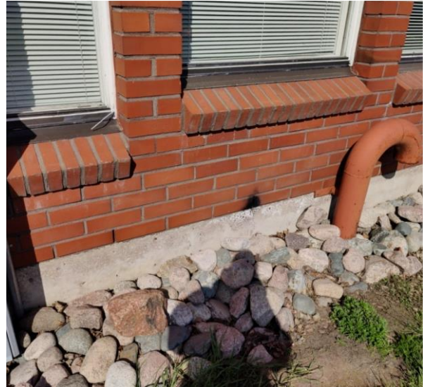
Kuva 17 Kuva itäisivustalta. Sokkelit ovat itäisivustalla parempikuntoisia muihin julkisivuihin verrattuna.
