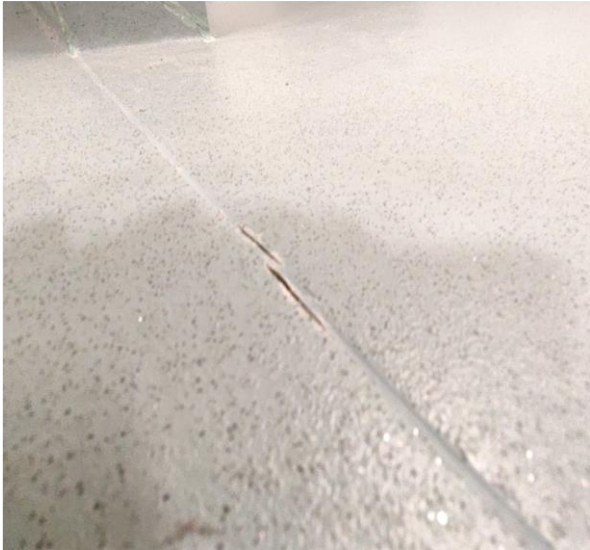
Kuva 60 Märkä- ja wc-tilojen päällysteiden tiiveydessä havaittiin paikoin puutteita. Kuva poikien pukuhuoneesta suihkun edustalta. Mattosaumassa on repeämä.
