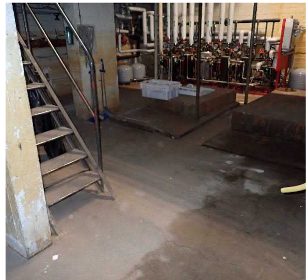
Kuva 51 Pannuhuoneessa todettiin alapohjaan imeytyneitä öljyhiilivetyjä.
