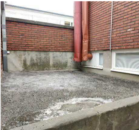
Kuva 9 Ala-asteen A1-pohjoissivusta. Maanpinnan korkeus lähellä kellarikerroksen ikkunoiden alareunaa, joka aiheuttaa kosteusrasitusta rakenteille.
