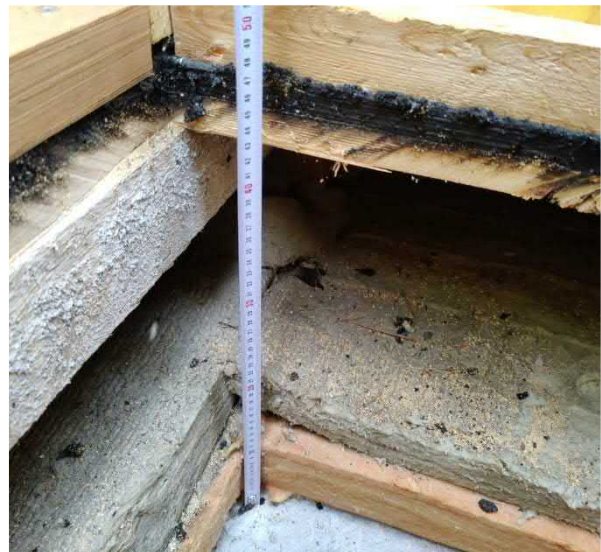
Kuva 103 Yläpohjarakenteen rakennekerroksen rakennusosalla B keittiön kohdalla. Yläpohjan kantavassa betonirakenteessa ei havaittu höyrynsulkerrosta.
