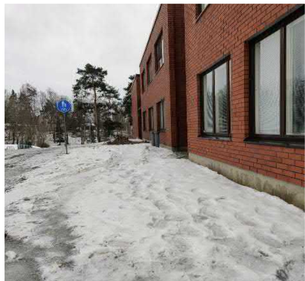
Kuva 18 Yläasteen osien B, C ja E2 pohjoissivustalla maanpinnan kallistukset ovat tasaisia ja sokkeleissa on havaittavissa kosteudesta aiheutuneita jälkiä ja värimuutoksia.
