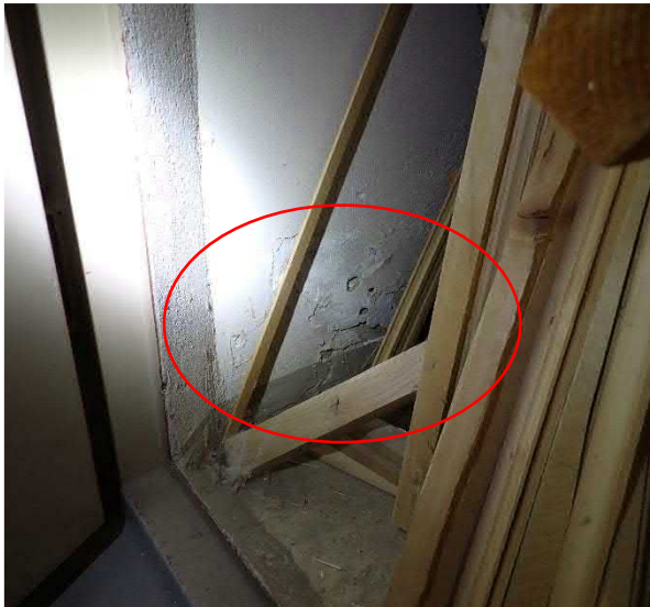
Kuva 36 Paikallista kosteusrasitusta maanvastaisen seinärakenteen sisäpinnassa puuvarastossa 018.
