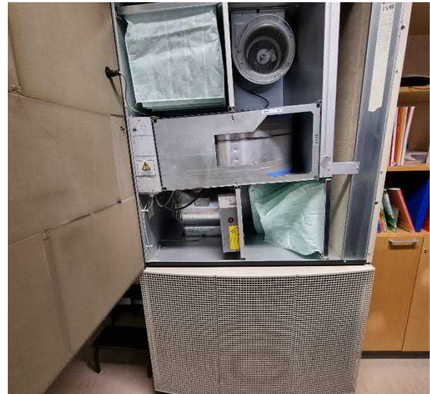
Kuva 164 Kiinteistönhuollon mukaan viimevuosina puhaltimia on jouduttu vaihtamaan useisiin CACA-mallin koneisiin.
