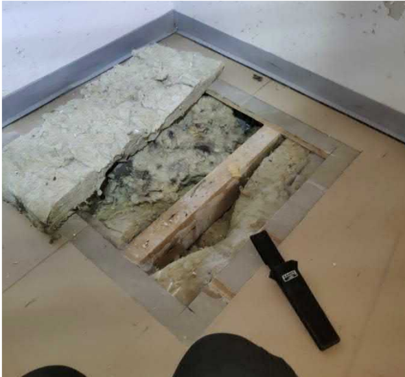
Kuva 58 Nykyinen ruokala on toiminut ennen liikuntasalina ja alapohjarakenteena on sisäpuolelta lämmöneristetty ja puukoolattu betonirakenne. Rakenteessa todettiin laajoja mikrobivaurioita ja ilmayhteys sisätiloihin.
