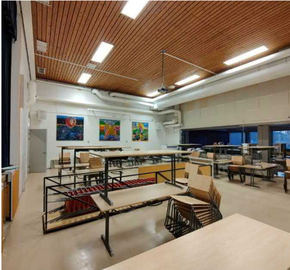
Kuva 190 Ruokasalin läpi kulkevaa kanavistoa katonrajassa.
