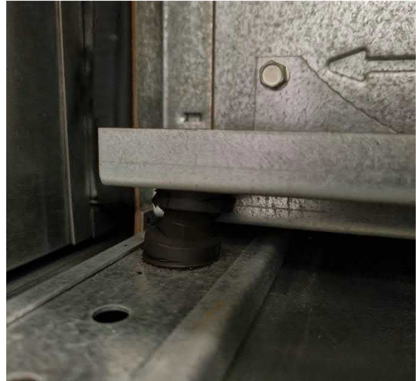
Kuva 159 TK3 puhallinjaluksen vaimennuskumi rikki.
