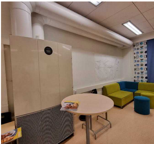
Kuva 199 Luokkakohtaisissa iv-koneissa tuloilmaa puhalletaan koneen alaosan säleiköstä ja poistoilma koneen sivusta/ylhäältä.
