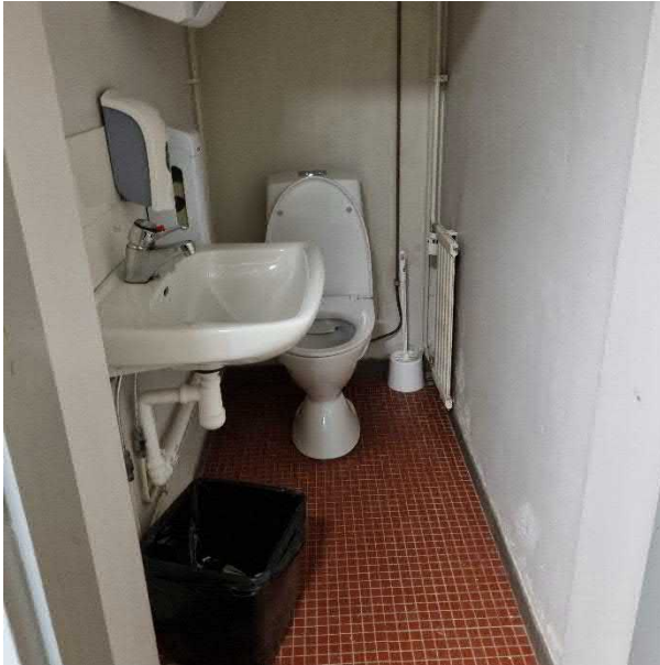
Kuva 135. Vesi- ja viemärikalusteita
