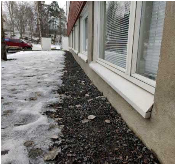
Kuva 3 Maanpinnan taso on lähellä ikkunoiden alareunaa alasteen A1 itäisivustalla.
