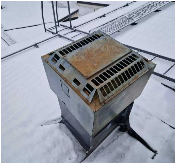
Kuva 171 Huippuimureiden laatat ovat kuluneet ja niiden tunnuksset/palvelualueet eivät ole vesikatol
