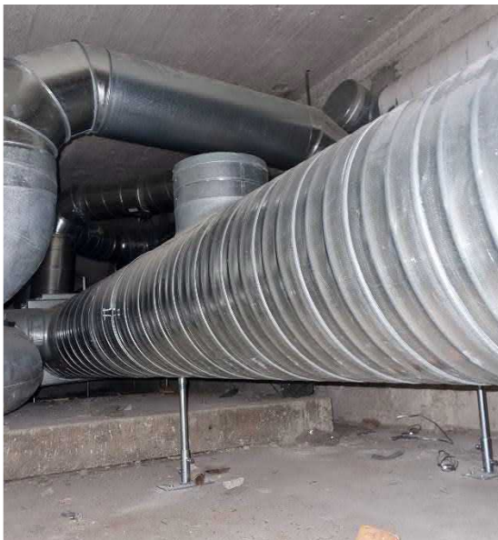
Kuva 188 D- ja A1-osan taitteen 2.kerroksen alakatosta on käynti iv-kanavatilaan. Kanavatilaan pääsy vaikeakulkuinen.
