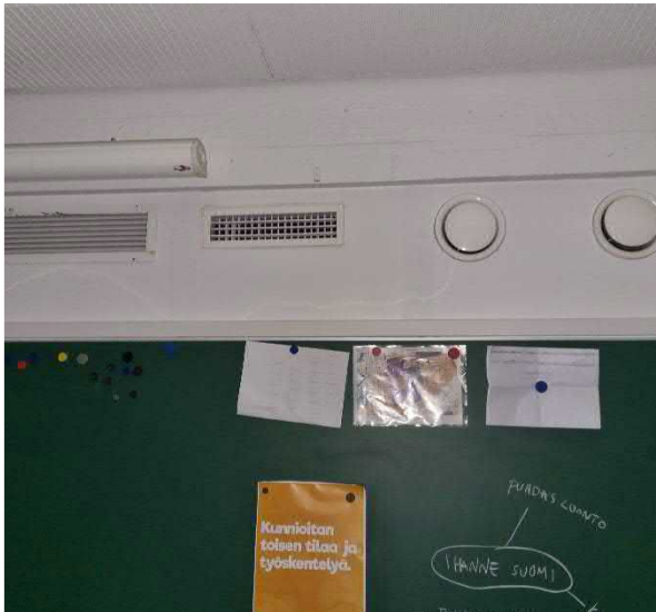
Kuva 193 Ala-asteen kellarikerroksen opetustilan tulo- ja poistoilmapäätelaitteet seinällä vierekkäin. Tuloilman heittokuvio ei huuhtelee luokan peräosaa.
