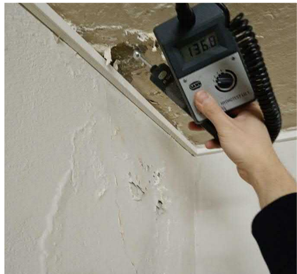
Kuva 93 Kohonneita pintakosteudenkartoituksen lukemia käännetyn kattorakenteen ja maanvastaisen seinän liitoskohdassa A1-osan kellarikerroksessa.
