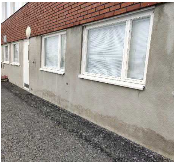
Kuva 5 Ala-asteen A1 eteläisivustalla havaittiin merkkejä kosteusrasituksesta sokkelien alaosassa.
