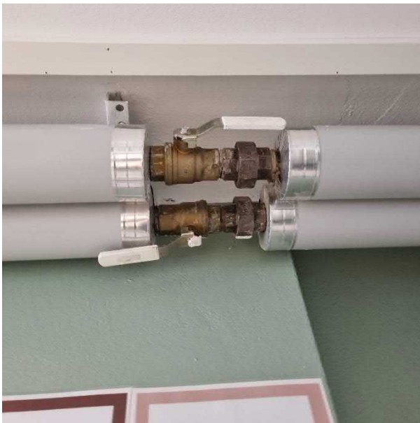
Kuva 112. Lämmitysverkoston sulkua ja säätöventtiilit ovat palloventtiileitä peruskorjausajankohdalta.
