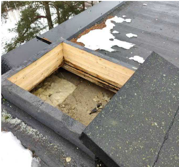
Kuva 104 Yläpohjan tarkastusluukku rakennusosan B itäpäädyssä. Yläpohjatilassa todettiin mikrobiperäistä ja tunkeista hajua.
