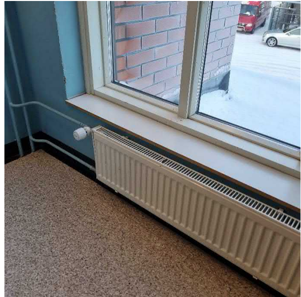
Kuva 117. Lämmitysverkoston pääteosat teräslevypatterit ovat alkuperäiskuntoisia sekä peruskorjausajankohdalta. Patteriventtiileitä ja niiden termostaattiosia on osin uusittu.
