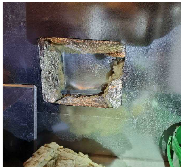
Kuva 149 TK01 raitisilmakammion tarkastusluukku on pieni ja hankalakäyttöinen.
