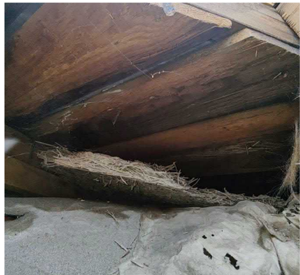
Kuva 97 Peltikatteen alapuolella on käytetty eriste- / tasauskerroksena kosteudesta herkästi vaurioituvia lastusementtilevjiä. Peltikatteen alla ei ole aluskatetta.
