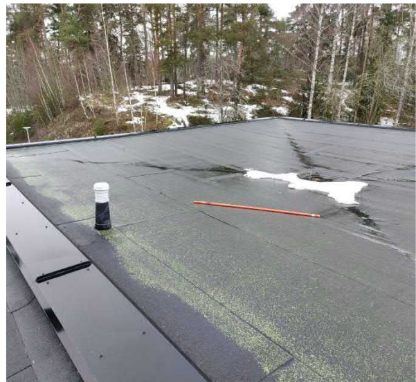
Kuva 107 Yleiskuva rakennusosan E2 vesikatolta. Vesikatteen pinnassa on huomattavasti sammalkertymää. Sadevedet ohjautuvat hyvin sisäpuoliseen sadevesijärjestelmään.
