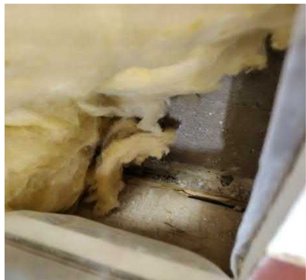
Kuva 39 Maanvastaisen seinän sisäpuolisen puukoolauksen alaohjauspuu sijaitsee alapohjan betonisen pintalaatan alapuolella. Rakenneavauksen kautta havaittiin voimakasta mikrobiperäistä hajua.
