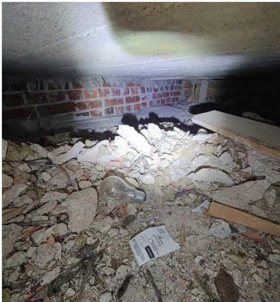
Kuva 96 Yläpohjatilassa havaittiin olevan runsaasti rakennusjätettä.
