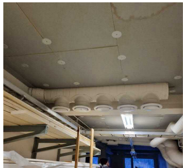
Kuva 196 Teknisen työn tilojen poistot ovat KSO-mallisia lautasventtiileitä.
