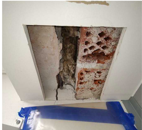
Kuva 86 Vanhan ulkoseinärakenne käytävällä B- ja C-osan välissä 1.kerroksessa. Rakenteen eristekerroksien kautta on suora ilmayhteys sisätiloihin mm. käytävien epätiiviyden alakattorakenteiden kautta.
