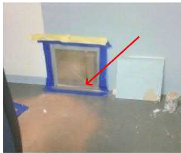
Kuva 43 Valokuva lämpökuvatusta rakenteesta.
