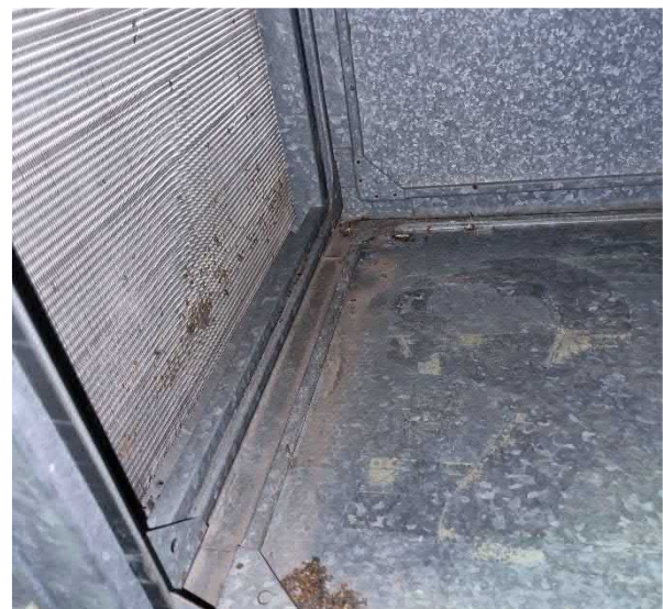
Kuva 146 Kammiot ja koneosat ovat tehostetun puhdistuksen tarpeessa. Kuvassa TK-3 tuloilmaosa.
