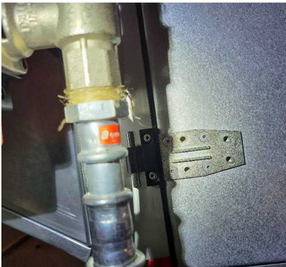
Kuva 152 TK03 huoltoluukun salpa on rikki.
