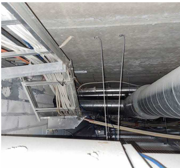
Kuva 187 C-osan 1.kerrosn käytävän alakatosta otetussa kuvassa havaittiin iv-kannakointien olevan osittain reikänauhalla kannakoituja.
