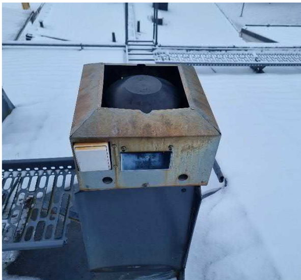
Kuva 173 PK-12 hissikuilun erillispoistopuhallin.
