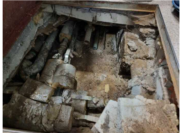
Kuva 123. Lattiarakenteessa vanhempia käytöstä poistettuja vesijohtoja.
