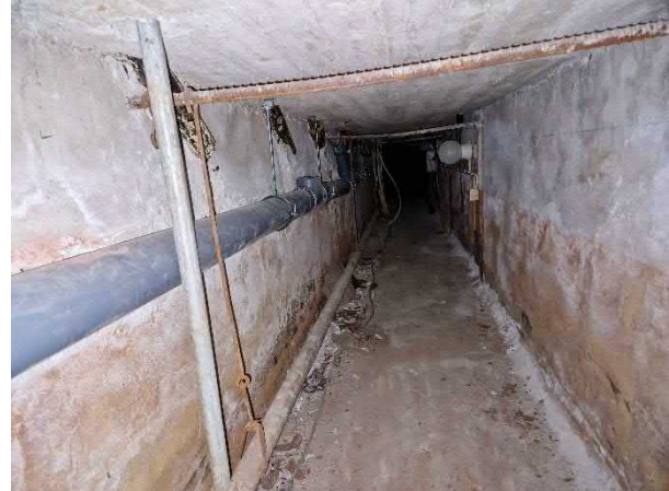
Kuva 130. Vanhalla osalla putkikanaalista huomaa, että suurelta osin vanhat viemärit poistettu ja korvattu muoviviemäreillä.
