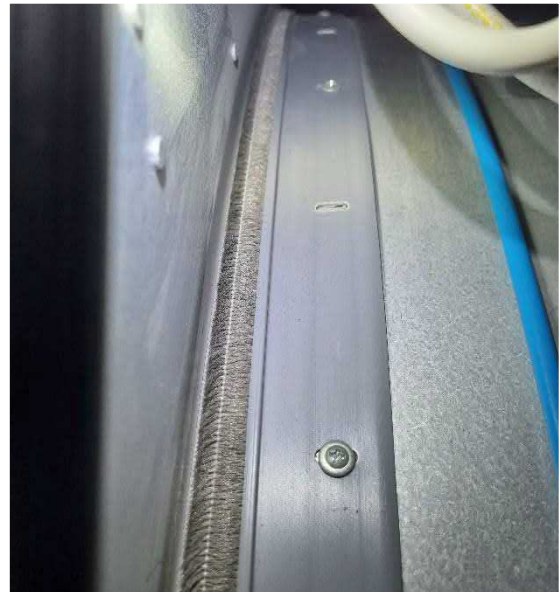
Kuva 153 TK03 LTO-kiekon harjakset kuluneet, LTO:ssa tapahtuu ohivuotoa.
