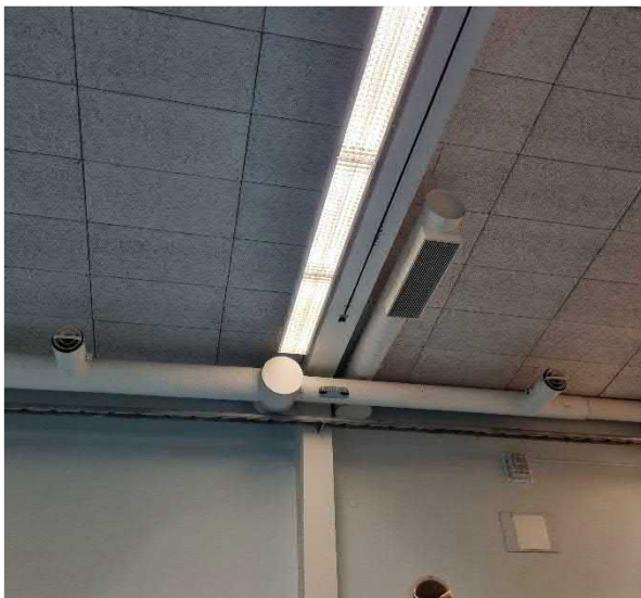
Kuva 191 Juhla- ja liikuntasalin tulo- ja poistopäätelaitteita.
