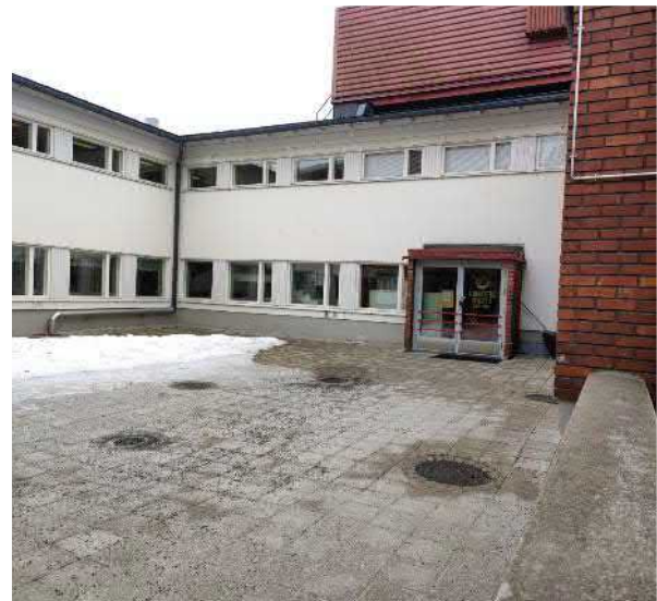
Kuva 10 Ala-asteen A1 sisäpiha sijaitsee osittain kellaritilan yläpuolella ja on toteutettu käännettynä kattorakenteena. Pihalueen sadevesienohjauksessa havaittiin paikallisia puutteita. Pihalaatoissa on runsaasti muodonmuutoksia ja pihakaivot ovat painuneet.
