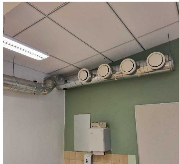
Kuva 192 A1-osan luokkatilojen ilmanvaihdon toteutusta. Kanavat ovat uudempaa tuotantoa, päätelaitemuutoksia on tehty jollain aikavälillä.
