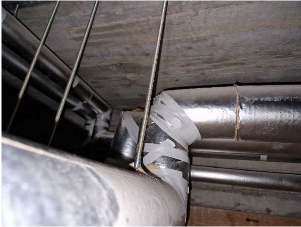
Kuva 126. Laajennusosalla putkia pinnoitettu alakattojen yläpuolella myös foliopinnoitein. Kannakoinnit paikoin ei täytä nykymääräyksiä.
