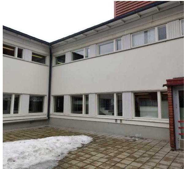
Kuva 91 Sisäpihan pihalaatoituksissa havaittiin jonkun verran muodonmuutoksia. Kellarikerroksessa todettiin kosteusvauriojälkiä käännetyn kattorakenteen ja maanvastaisten seinärakenteiden liitoskohdissa
