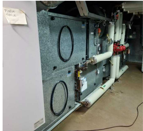
Kuva 144 TK-2 ja Tk-3 palvelevat alakoulun liikuntasalia ja teknisen työn luokkaa (tuloilmakone).
