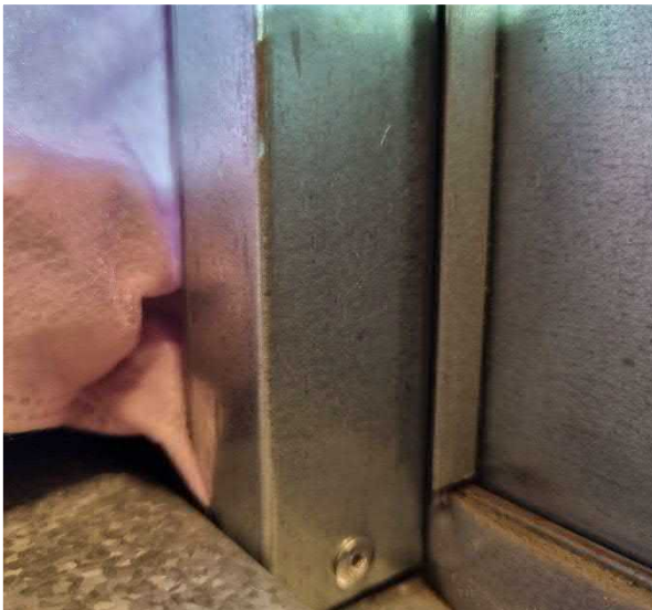
Kuva 160 TK3 suodatinosassa havaittiin epätiiveyttä ja ohivuotoa.
