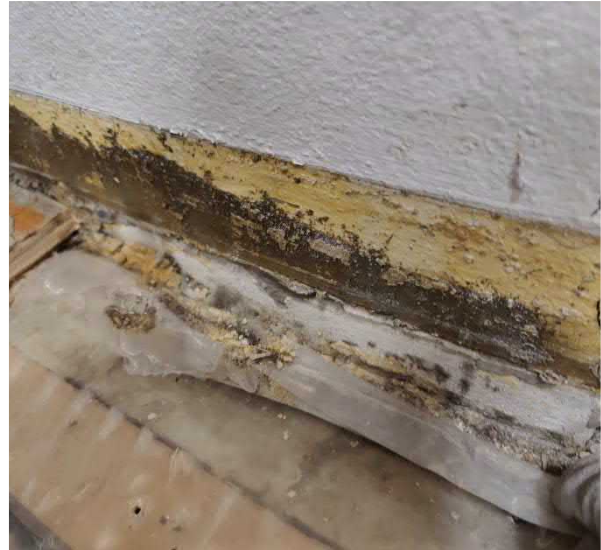
Kuva 59 Ruokalan alapohjarakenne ei ole tiivis reuna-alueilta. Lisäksi rakenteen kautta on ilmayhteys keittiön vastaisen, vanhan ulkoseinärakenteen eristekerrokseen ja sitä kautta sisäilmaan.
