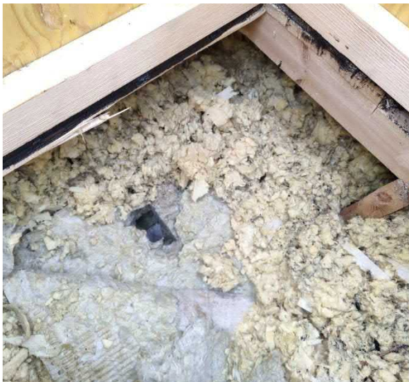
Kuva 106 Rakennusosan C yläpohjarakenteen levyristeiden pinnassa on puhallusvillaa.
