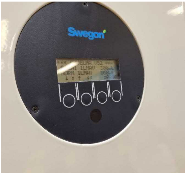
Kuva 165 Näyttöpäätteeltä asennetaan iv-koneen ilmamäärät.
