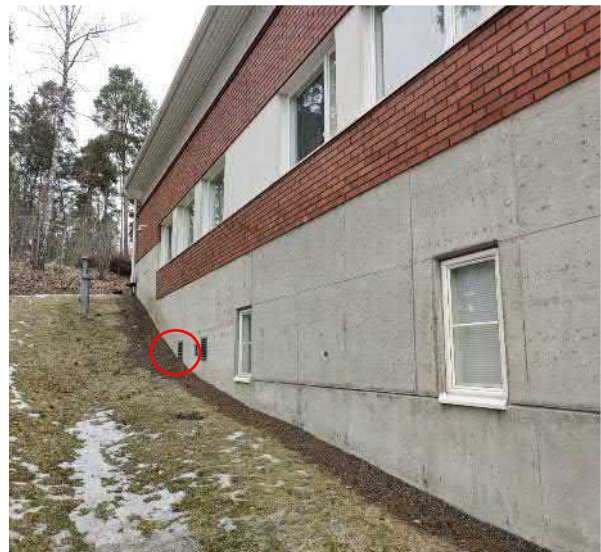
Kuva 14 Yhdysosan D länsisivustalla ei todettu puutteita pintavesien ohjauksessa. Vierustalla havaittiin metallinen säleikkö, joka sijaitsee osittain maanpinnan tason alapuolella.
