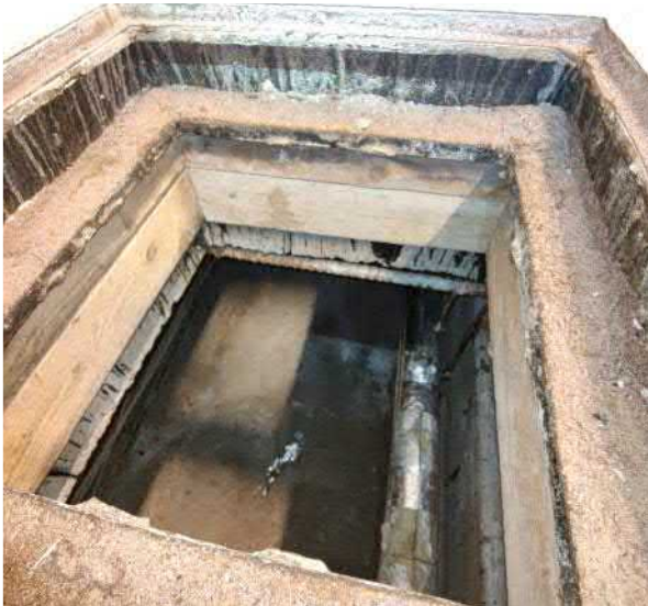
Kuva 48 Alkuperäisten 1950-luvulla rakennettujen rakennusosien alapohjassa kulkee useita tekniikkakanaaleita. Osaan kanaaleista on kulkuyhteys ja osa on matalampia, vanhojen lämpölinjojen asennuskanavia.
