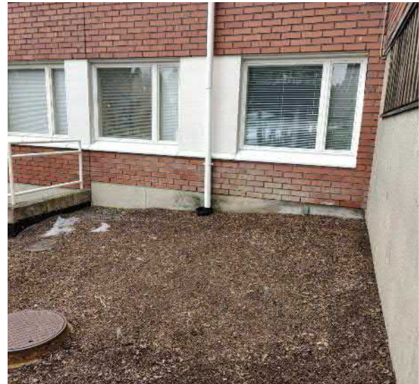
Kuva 20 Yhdyskäytävän D itäisivustalla, väestönsuojan kohdalla havaittiin kosteuden aiheuttamaa rasitusta sokkelien pintarakenteissa ja ulkoseinä rakenteen alaosassa.
