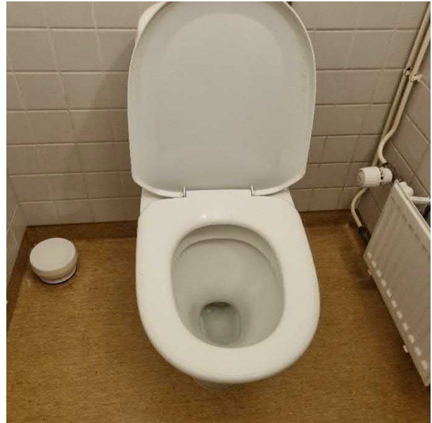
Kuva 138. 153 wc vuoti ajoittain läpi, jos painike ei laskeutunut. Lisäksi tilassa alipaineventiili.
