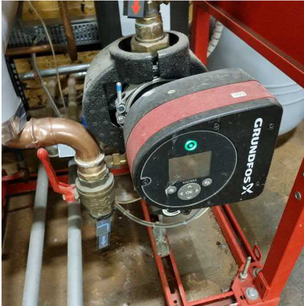
Kuva 110. Kiertovesipumput on uusittu keskusosien uusimisen yhteydessä.
