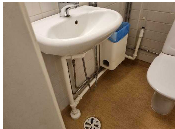
Kuva 134. Vesi- ja viemärikalusteita
