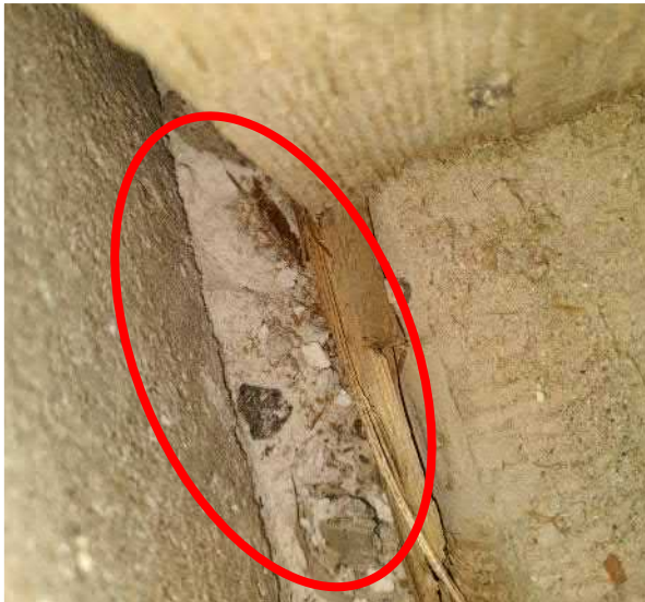
Kuva 40 Kalkkihärmää maanvastaisen betoniseinän alaosassa.
