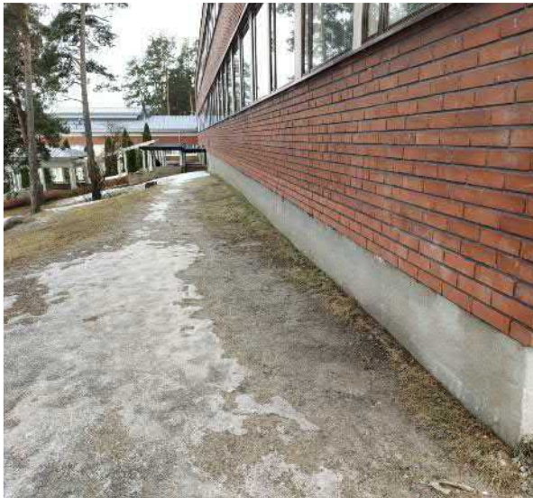
Kuva 19 Yläasteen B-osan eteläsivustalla maanpinta kallistaa voimakkaasti pois päin rakennuksesta.
