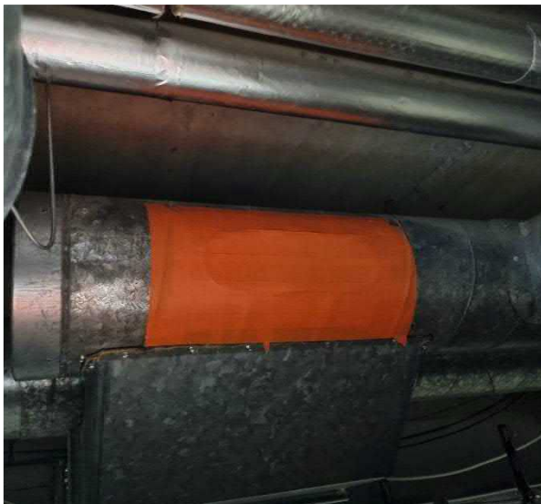
Kuva 185 Avoin puhdistusluukku teipattiin umpeen.
