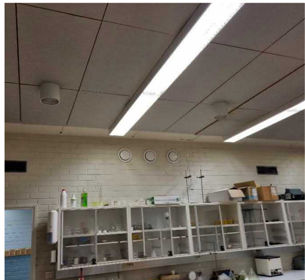
Kuva 200 Fysiikka ja kemian luokan Y111 tulo- ja poistoilmapäätelaitteet ovat alkuperäisiä seinämällisiä, joiden äänieristevillat ovat lähtötietojen perusteella uusittu/vaihdettu polyesterimateriaaliin.
