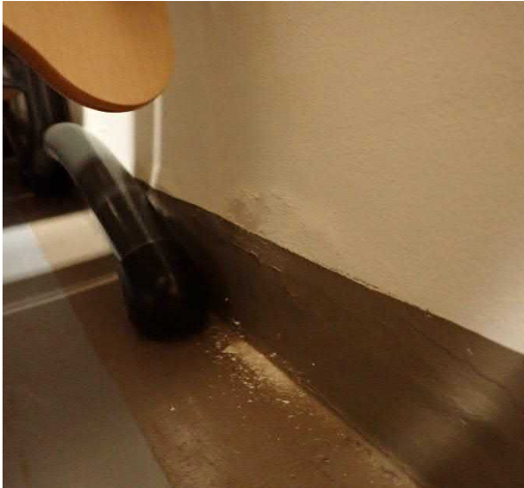
Kuva 47 Paikallista maalipinnan / tasoitteen hilseilyä maanvastaisen seinärakenteen alaosassa tilassa 122.
