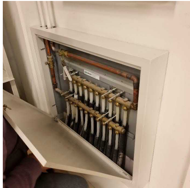
Kuva 119. Lattialämmityksen jakotukki. Lattialämmityspotket ovat materiaailtaan muovia.
