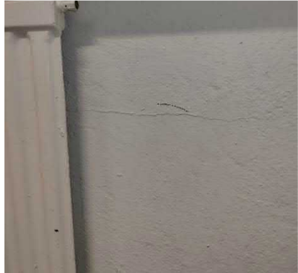
Kuva 33 Esikoulun käytävän patterisyvennyksen osalta todettiin halkeilua ja epätiiveyttä sisäpuolisessa rappaus- ja maalikerroksessa.
