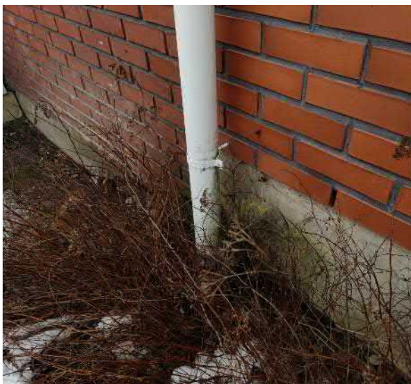
Kuva 21 Yhdyskäytävän D ja Ala-asteen A1 liitoskohdassa itäisivustalla todettiin puutteita sadevesien ohjauksessa. Sokkelissa ja tiiliverhoilun alaosissa todettiin kosteuden aiheuttamia jälkiä.
