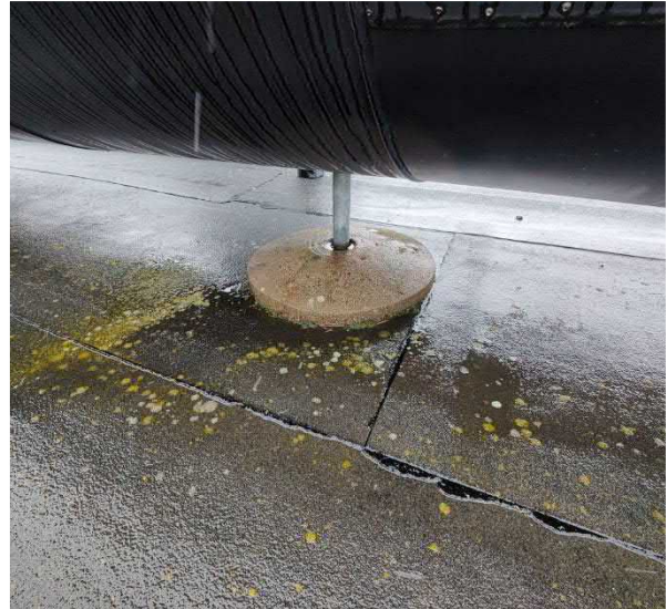
Kuva 101 Huopakate on havaintojen perusteella ikääntynyttä ja sen pinnalla todettiin sammalkasvustoa useassa pisteessä.
