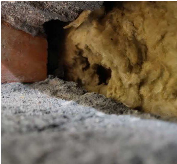
Kuva 85 Vanha ulkoseinärakenne C- ja B-osien välissä. Rakenne toimii nykyään sisäseinärakenteena. Alapohjarakenteen läheisyyteen tehdyissä avauksissa todettiin voimakasta mikrobiperäistä hajua rakenneavausten kautta.
