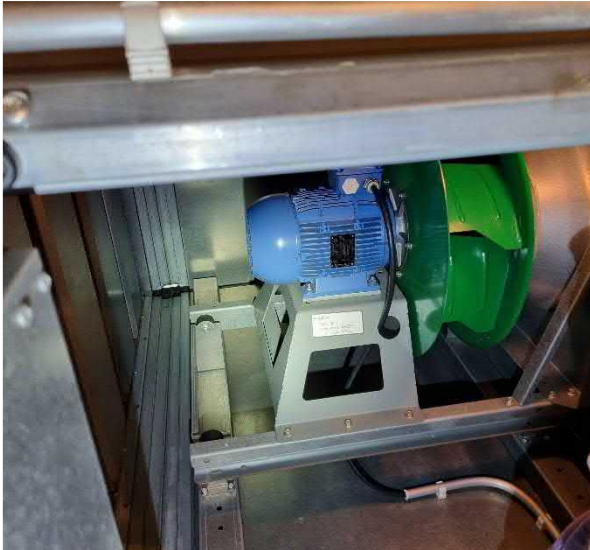
Kuva 150 TK01 suoravetoinen puhallin, joka on varustettu taajuusmuuntajaohjauksella.
