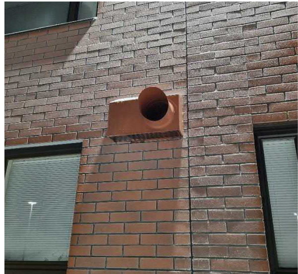
Kuva 168 Tilakohtaisten iv-koneiden ilman sisäänotto ja ulospuhalluslaitteet sijaitsevat ulkoseinillä.
