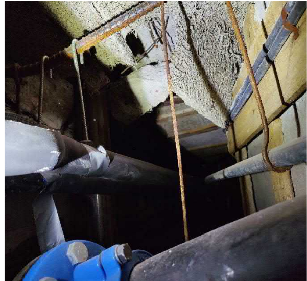
Kuva 53 Lastusementtilevyjä kanaalin yläpinnassa. Levyissä todettiin vaurioita aistinvaraisesti.
