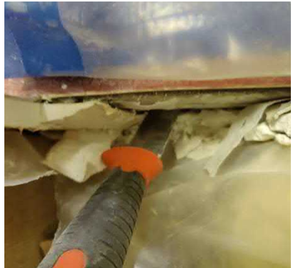
Kuva 41 Alapohjarakenteen eristetilasta on ilmayhteys sisätilaan maanvastaisen seinärakenteen liitoskohdassa.
