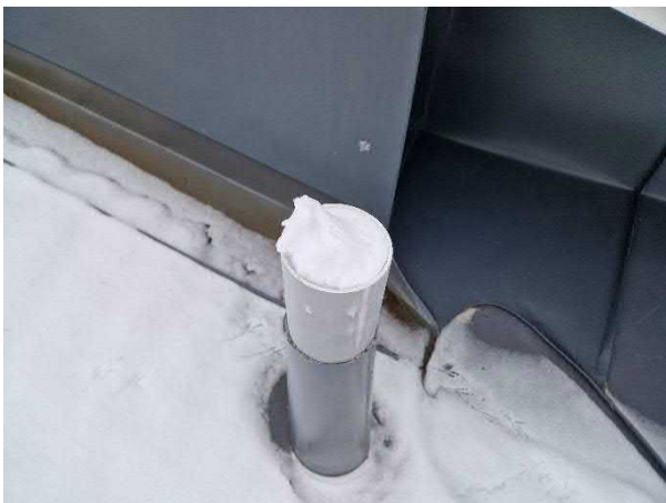
Kuva 133. Tuuletusviemäreitä on havaintojen mukaan riittävä määrä, mutta osa oli jäänyt umpeen.
