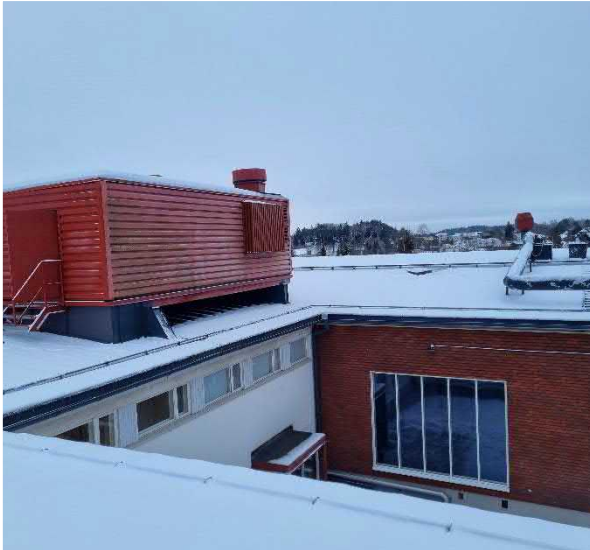
Kuva 147 "Konttikonehuone" vesikatolla. Raitisilmanotto tapahtuu lumisäleikön avulla seinästä, jäteilmat puhalletaan ylöspäin katolla sijaitsevista ulospuhalluslaitteista.
