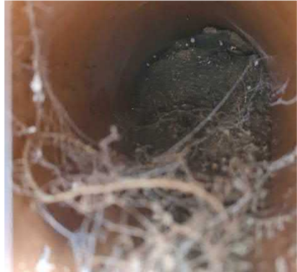
Kuva 30 Alkuperäinen salaojaputki on tukossa maa-aineksestä 1970-luvun osalla.
