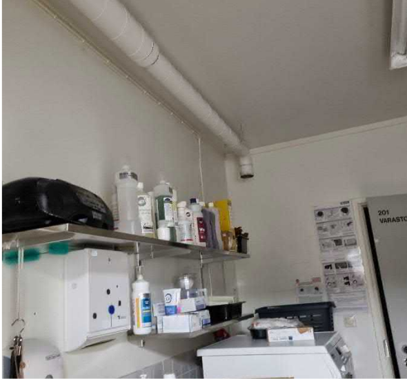
Kuva 203 Siivouskeskuksesta 202 puuttuu poistoilmaventtiili.
