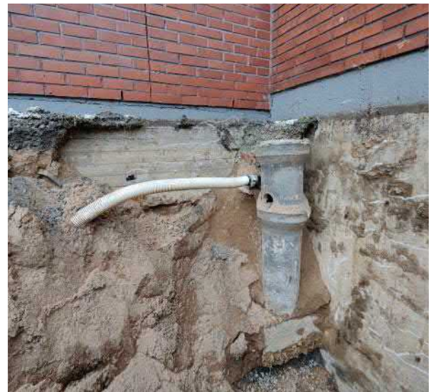
Kuva 24 Maa-aines on rakennusosien vierustoilla hienojakoista hiekkaa. Muovinen salaojaputki sijaitsee 1980-luvun osalta anturapinnan yläpuolella. Perusmuurien ulkopinnassa ei ole veden- tai lämmöneristekerroksia.
