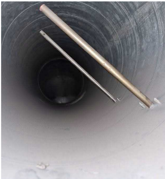
Kuva 181 Teknisen työn luokkien poistoilmakanavat ovat puhdistuksen tarpeessa.
