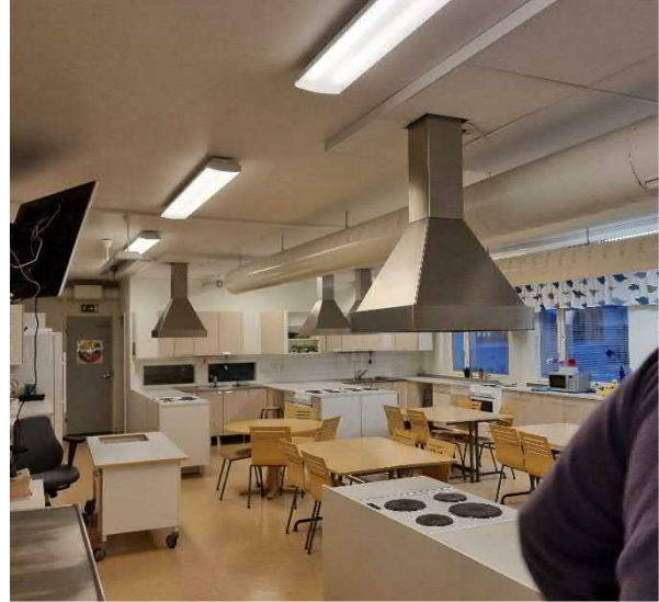
Kuva 204 Kotitalousluokan 211 huuvat ovat RST-huuvia, tuloilma tuodaan suutinkanavilla keskeisesti tilaan.
