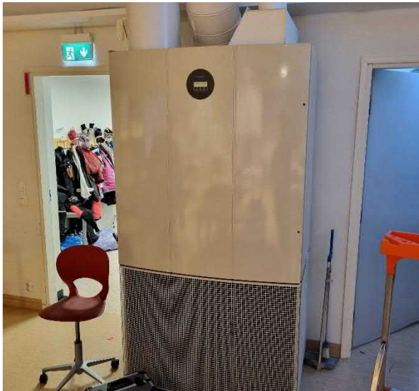
Kuva 163 Tilakohtainen iv-kone Swegon CACA.
