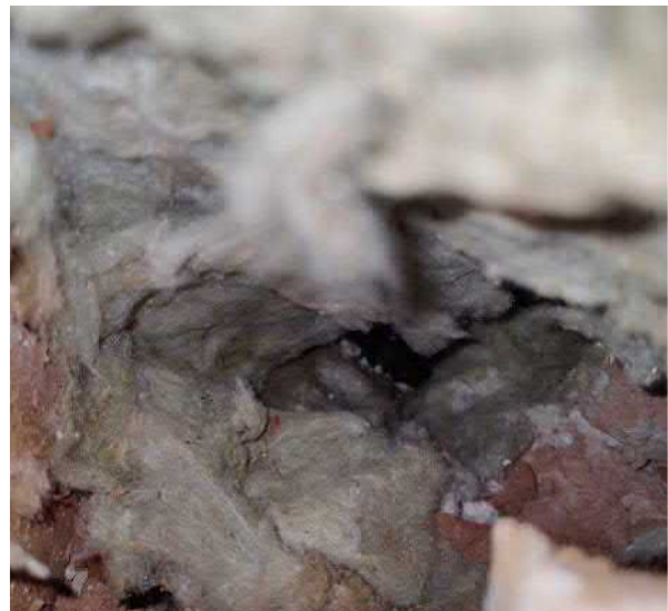
Kuva 35 Sisäpuolinen eristekerros ja tiiliverhoilu jatkuu maanvastaisten seinien osalta lattiapinnan alapuolelle. Eristekerroksissa todettiin kosteusrasitukseen viittaavia jälkiä ja mikrobivaurioita.
