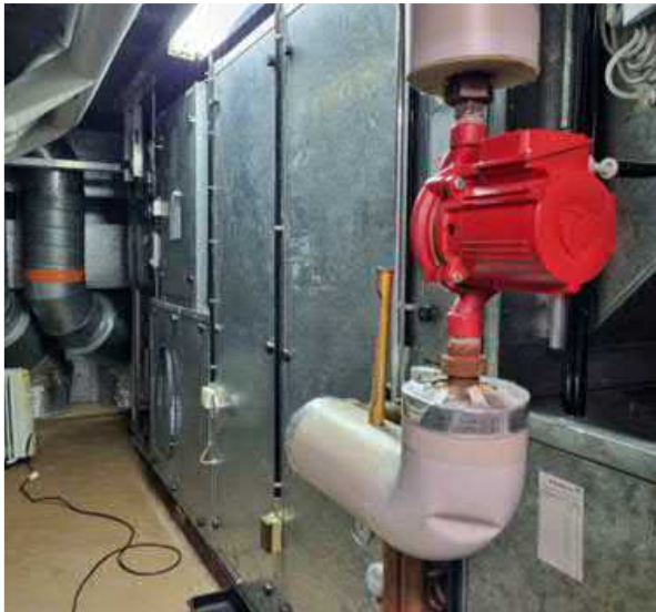
Kuva 143 Yleiskuva TK-1 ilmanvaihtokoneesta.
