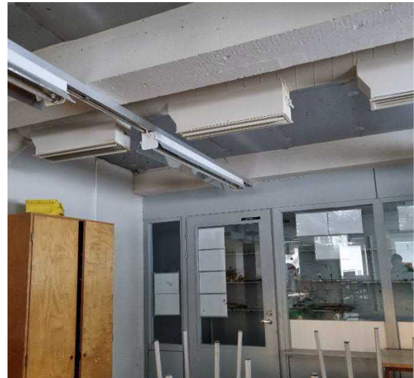
Kuva 194 Puutyöluokan ilmanvaihdon päätelaitteita.
