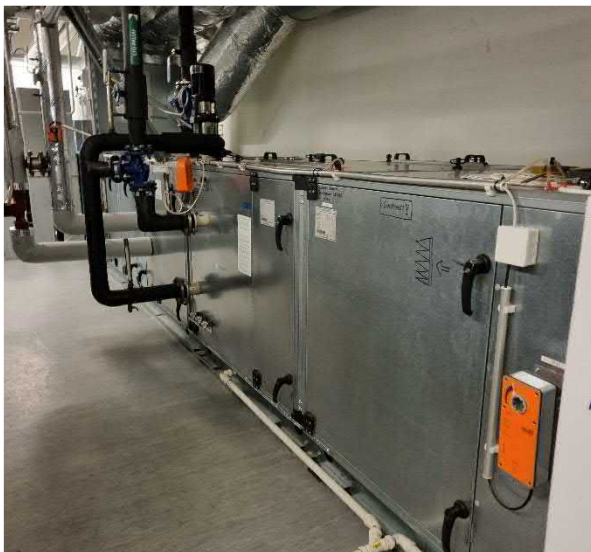
Kuva 148 Yleiskuva keittiön tuloilmakoneesta TK01.
