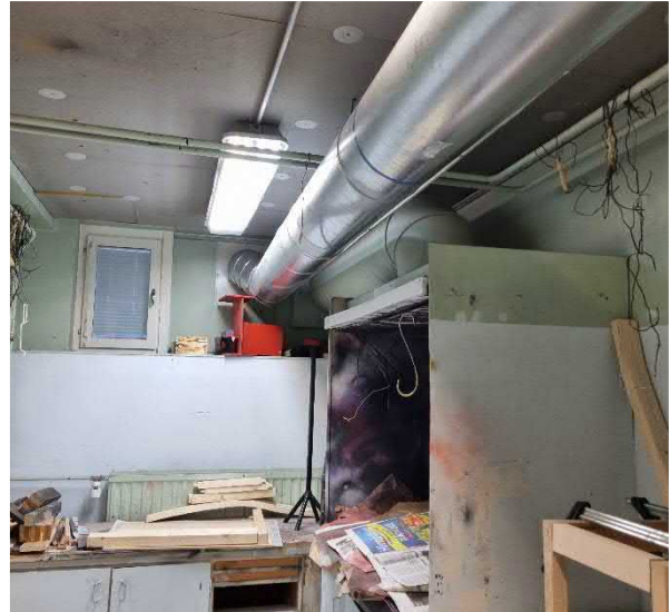
Kuva 180 Maalauskaappi ja erillispoistokanavistoja.
