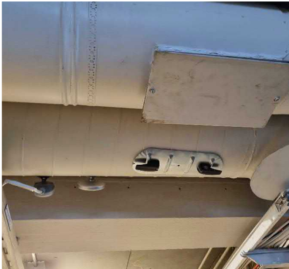
Kuva 175 Ala-asteen kellarikerroksen teknisten työn tilojen siirtokanavistoja. Puhdistusluukku on lisätty jälkeinpäin.
