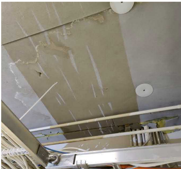
Kuva 92 Vesivuotojälkiä kellarin alakattorakenteissa.
