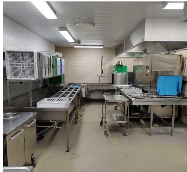
Kuva 206 Keittiön huuvat ovat Climecon-merkisiä. Aistinvaraisesti tarkestellen huuvat ovat hyväkuntoisia ja siistejä.
