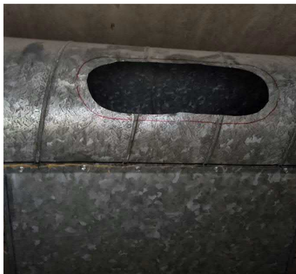
Kuva 184 Käytävän alakatosta paljastui ilman puhdistusluukku oleva kanavaosa.
