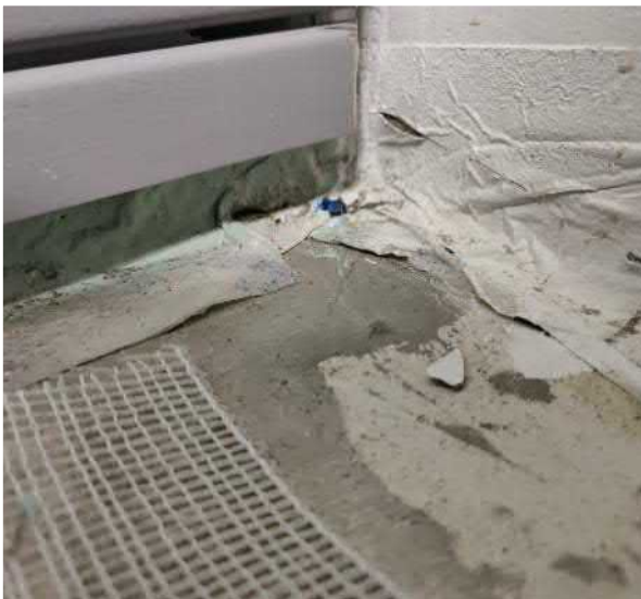
Kuva 50 Tilan 011 maanvastaisen seinärakenteen ja alapohjan liitoskohdassa havaittiin tiivistysnauha, joka ei ollut alapohjarakenteeseen tehtyjen merkkiainekokeiden perusteella tiivis.
