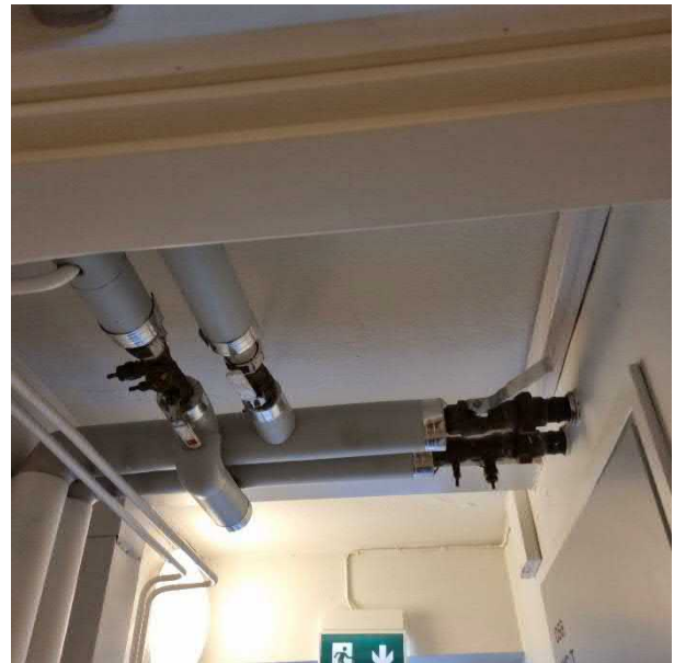
Kuva 113. Lämmitysverkoston sulkua ja säätöventtiilit ovat palloventtiileitä ja ne on havaintojen perusteella tasapainotettu.
