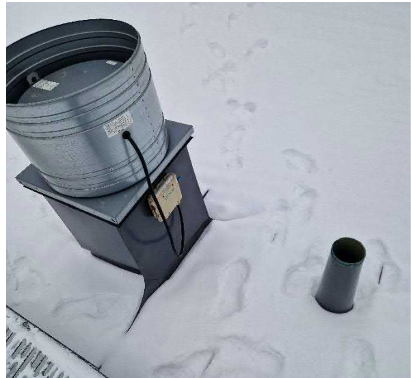
Kuva 172 lältään uudempi huippuimuri.
