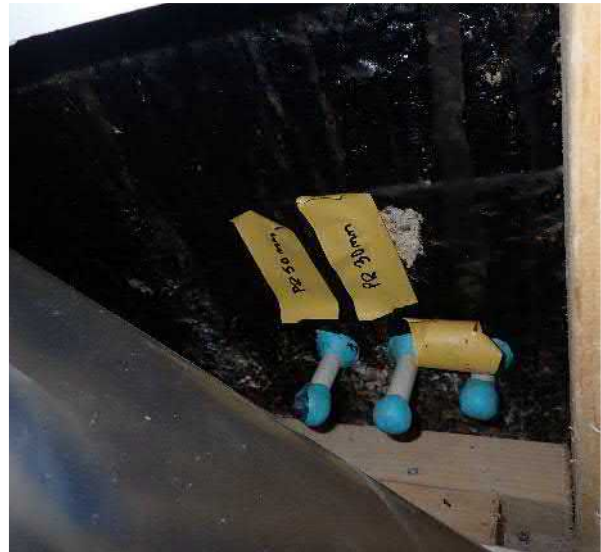
Kuva 45 Rakenteen MS2 kantavan ulkokuoren sisäpinnassa on vedeneristekerros. Vedeneristeen alaosassa todettiin puutteita kuten vedeneristeen irtoamista. Ulkokuoren betonirakenne on mittausten perusteella kostea.
