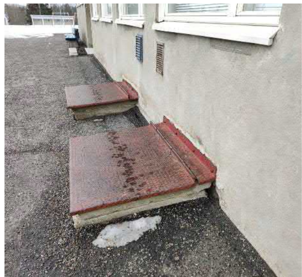
Kuva 6 Ala-asteen A1 eteläisivustalla sijaitsevat metalli- / betonirakenteiset luukut sekä liittymät seinärakenteisiin eivät ole sadevesitiiviitä.
