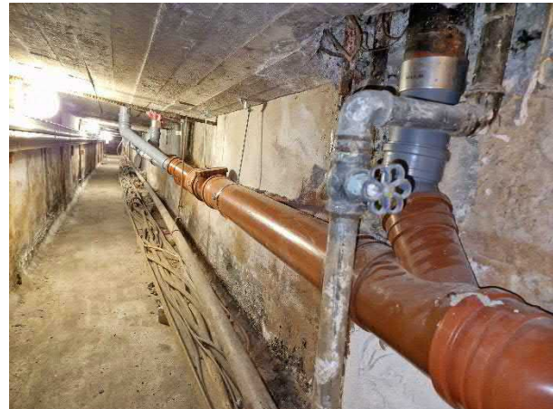
Kuva 132. Kannakoiteja ei kaikilta osin ole tehty nykymääräysten mukaisesti. Haaraliitoksien molemmin puolin tulisi olla kannakoinnit.
