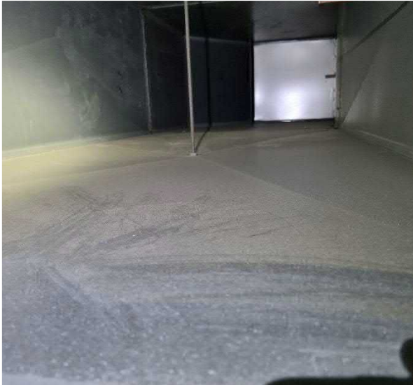
Kuva 154 TK03 kammioissa havaittiin pölyä.
