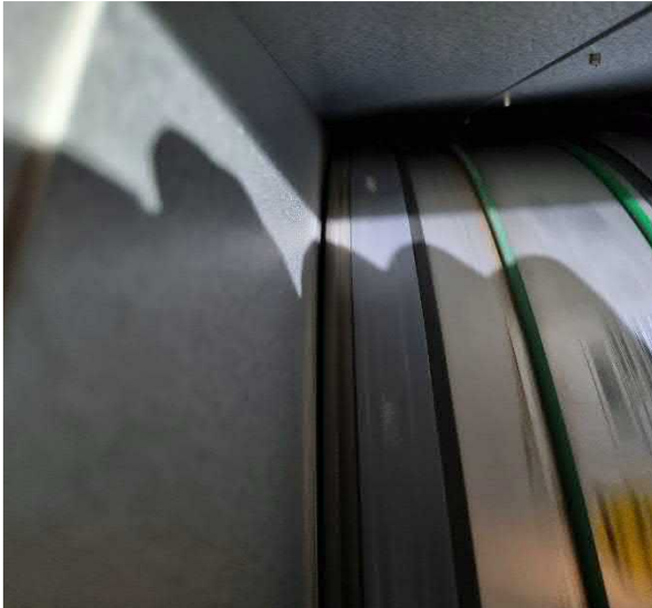
Kuva 158 TK02 LTO-roottorin harjakset kuluneet, LTO-osan ohi tapahtuu ohivuotoa ja lämmöntalteenoton hyötysuhde heikkenee.
