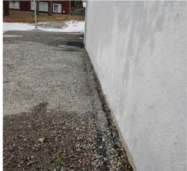
Kuva 12 Ala-asteen A2 vierustoilla asvaltin ja sokkelin liitoskohtaan on muodostunut rako.
