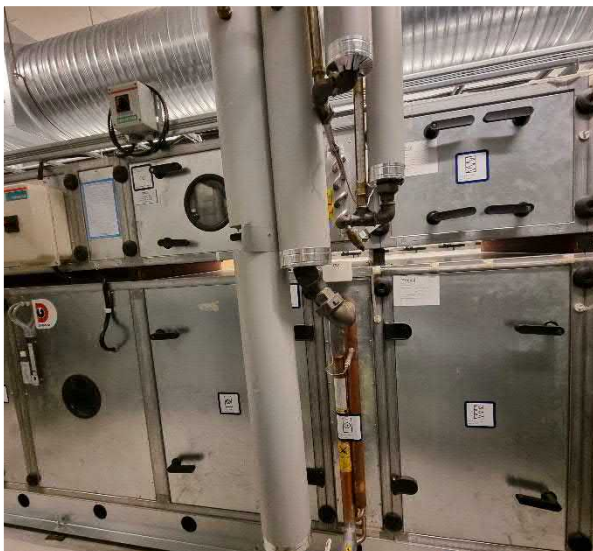
Kuva 156 TK-1 ja TK3 koneet päällekkäin.
