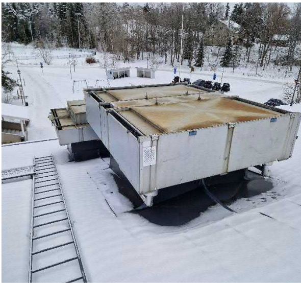
Kuva 169 Retermia LTO:lla varustettuja erillispoistoja.
