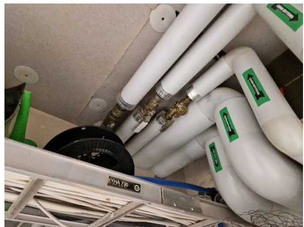
Kuva 125. Käyttövesiverkoston sulku- ja säätöventtiilit ovat peruskorjausajalta olevia palloventtiileitä.
