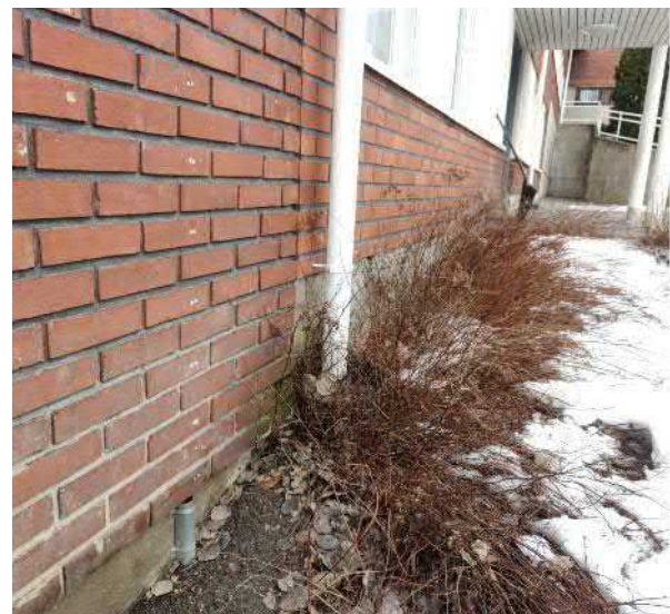
Kuva 22 D- ja A1-osien liitoskohdassa havaittiin kasvillisuutta, joka sijaitsee kiinni rakennuksessa.
