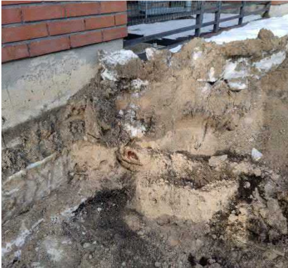
Kuva 29 1970-luvulla rakennetun B-osan itäsivustalle kaivettu koekuoppa. Salaojitus on alkuperäinen, sijaitsee anturan alapinnan yläpuolella ja se on toteutettu tiiliputkella. Maa-aines on vierustalla hienojakoista. Betoninen nauha-anturalinja tukeutuu kallioon.
