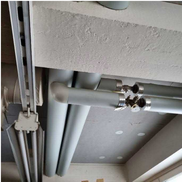
Kuva 116. Lämmitysverkoston putkieristeinä käytetty mineraalivillaa ja pinnoitettu pvc-pinnoite.
