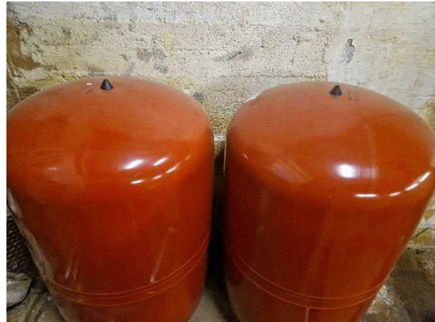
Kuva 109. Kalvopaisunta-astiat on uusittu jakokeskuksen uusimisen yhteydessä.
