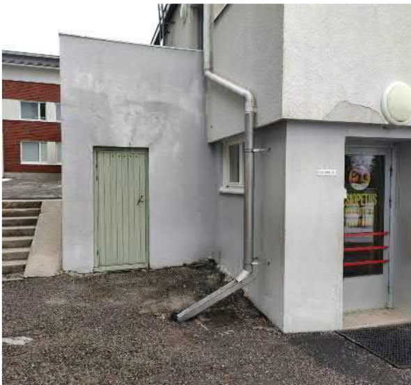
Kuva 13 Ala-asteen A2 luoteiskulmauksessa sokkelin ja asfaltin liitoskohdassa asfalttipinta on painunut ja sokkelin alaosassa todettiin merkkejä kosteusrasituksesta.
