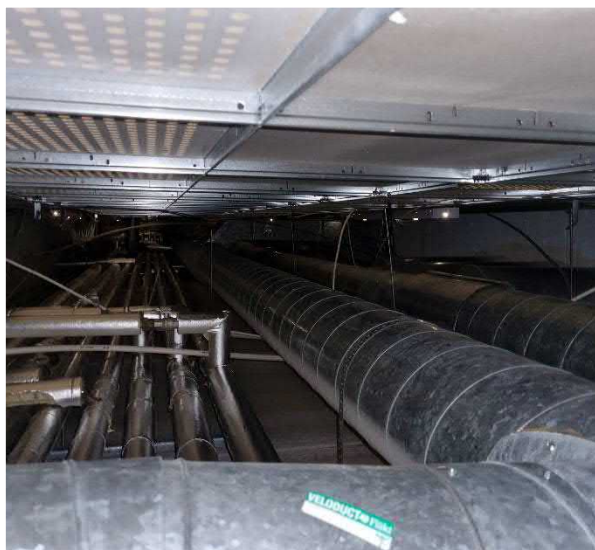
Kuva 183 Käytävien alakatoissa kulkevaa tekniikkaa.
