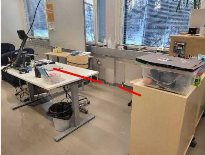
Kuva 34 Alapohja-ulkoseinä liittymä vuotaa merkittävästi
