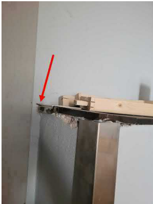
Kuva 18 Ikkunapenkit liittymät vuotavat merkittävästi
