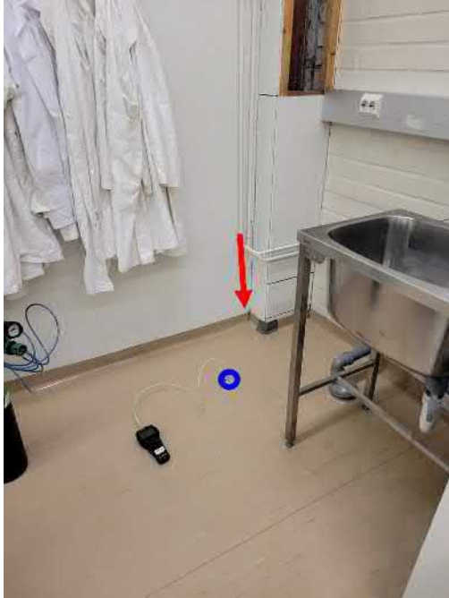
Kuva 38 Merkkiainekokeen syöttöpiste alapohjaan. Alapohja ja kotelon liittymä vuosi laajalti.
