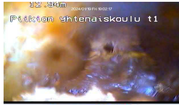
Kuva 8. Padottavaa likaa putkessa.
