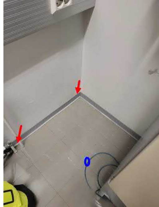
Kuva 30 Nurkka vuotaa pistemäisesti.
