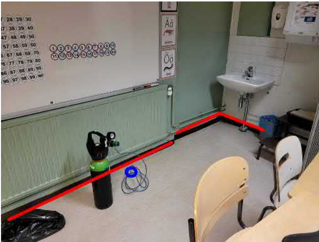
Kuva 27 Alapohjan ja ulkoseinän liittymä vuotaa merkittävästi
