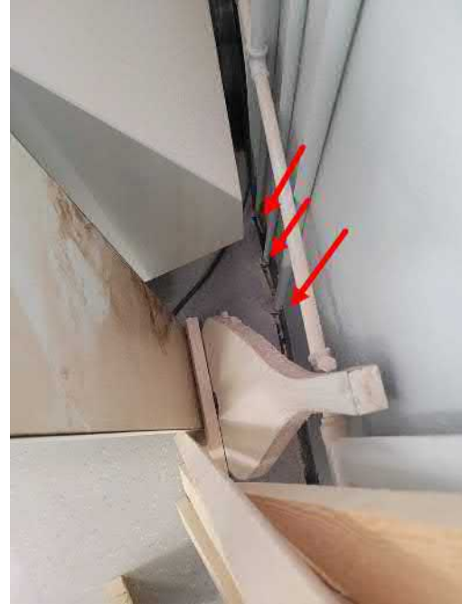
Kuva 23 Alapohjan putkiläpiviennit vuotaa merkittävästi.
