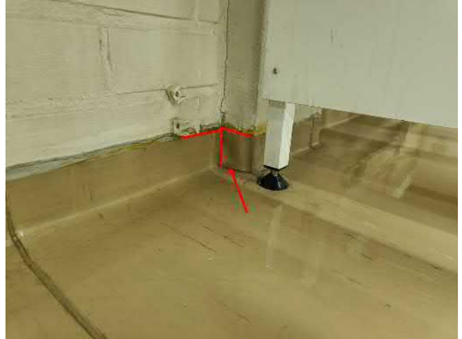
Kuva 56 Voimakasta vuotoa pilarin ja mattonoston liitoksissa. Liistoskohta hieman avonainen.
