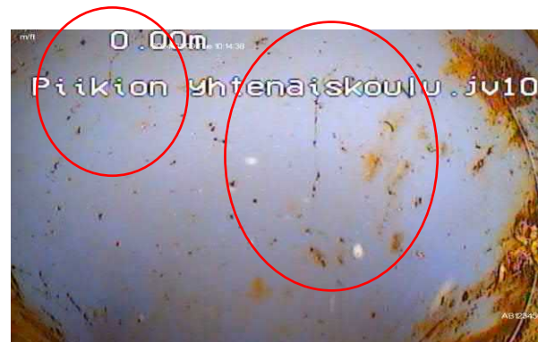
Kuva 4. Hiushalkeamat mutkaosan yläosassa
