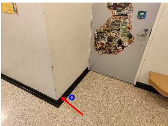
Kuva 50 Voimakas vuoto jalkalistan yläpinnasta.
