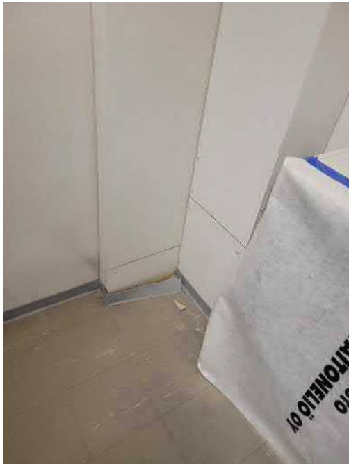
Kuva 31 Aistinvaraisesti kotelo epätiivis
