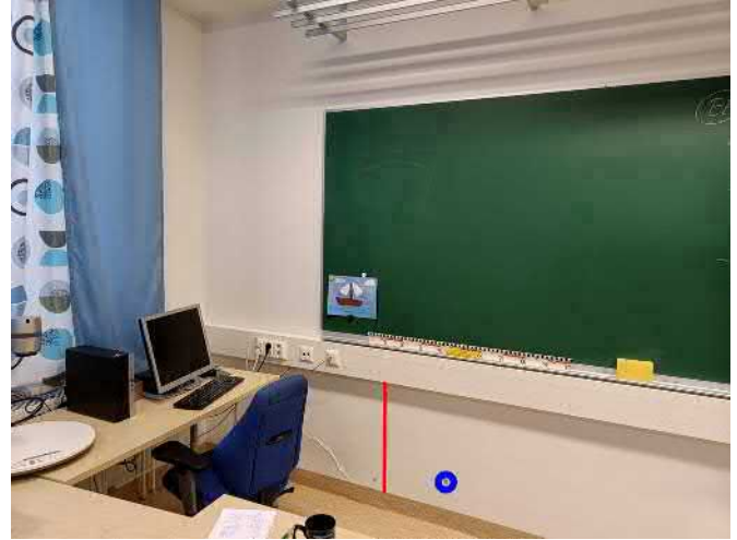
Kuva 54 Pistemäisiä, mutta voimakkaita vuotokohtia väliseinässä olevassa saumassa.
