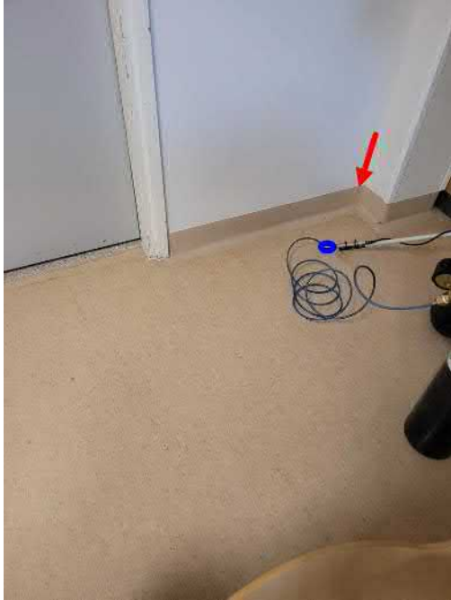
Kuva 9 Pilatin liittymä vuotaa
