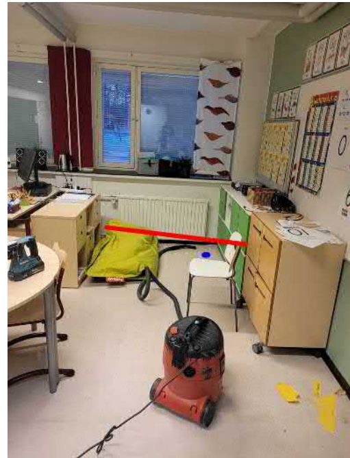
Kuva 28 Alapohjan ja ulkoseinän liittymä vuotaa merkittävästi
