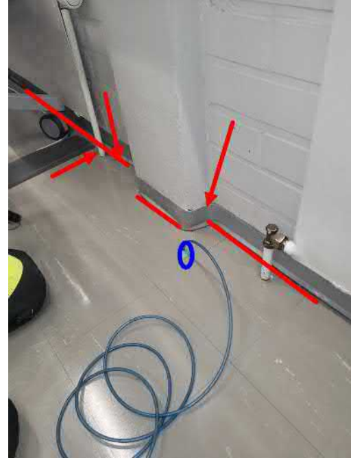
Kuva 35 Alapohja-ulkoseinä liittymä vuotaa merkittävästi. Merkkiainekokeen syöttöpiste alapohjaan
