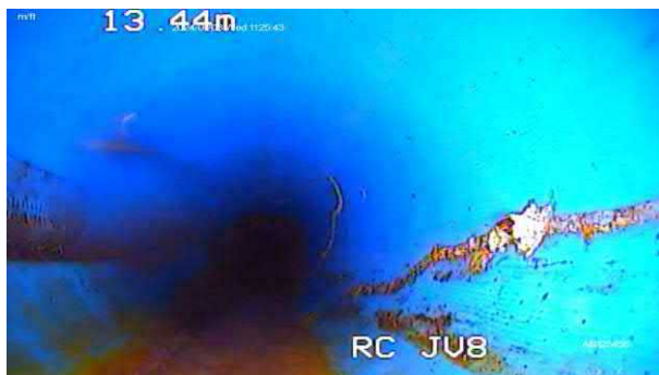
Kuva 3. Sukka mahdollisesti rikkoutunut, ruoste puskee läpi.
