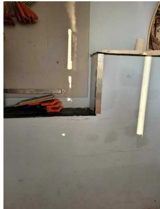
Kuva 19 Maanvastaisenseinän halkeamat vuotavat merkittävästi
