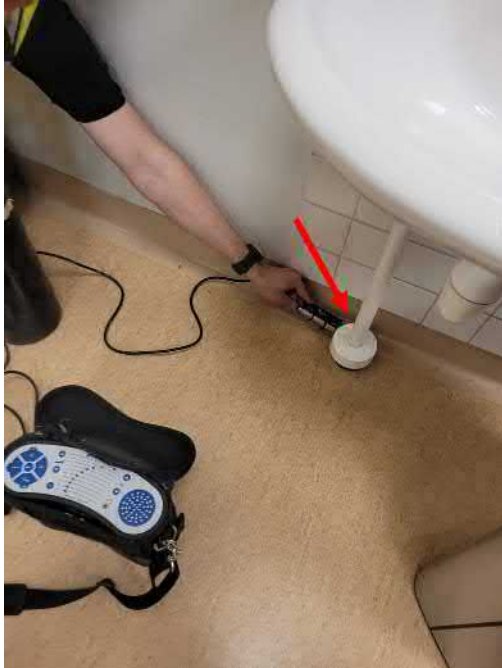
Kuva 3 Altaan läpivienny vuotaa
