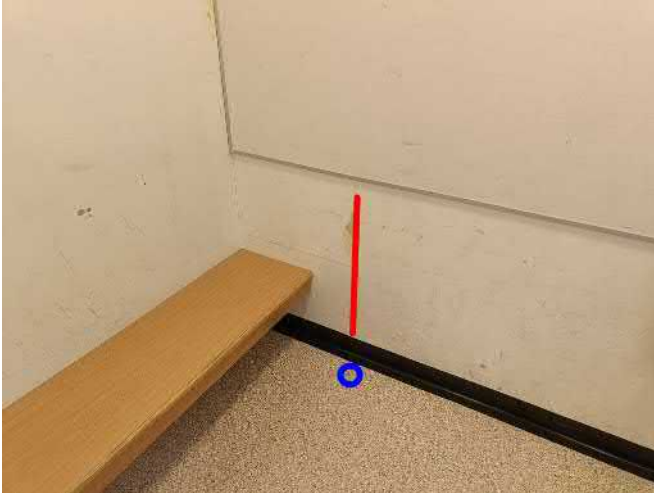
Kuva 52 Voimakasta vuotoa ulkoseinä-kotelorakentee liitoksessa.
