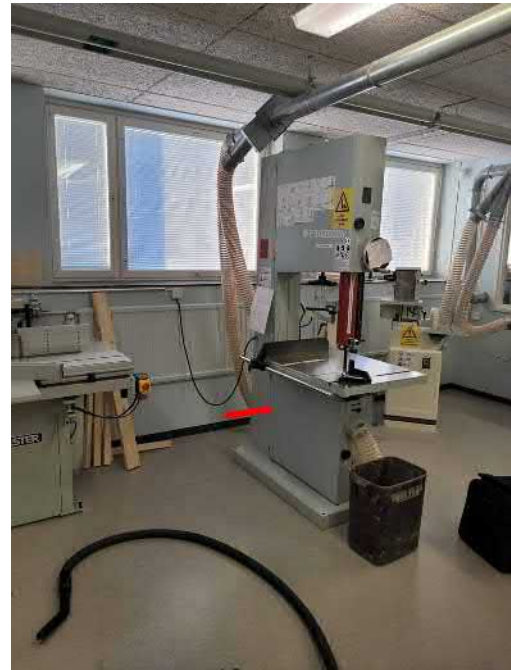
Kuva 21 Alapohjan ja seinän liittymä vuotaa merkittävästi
