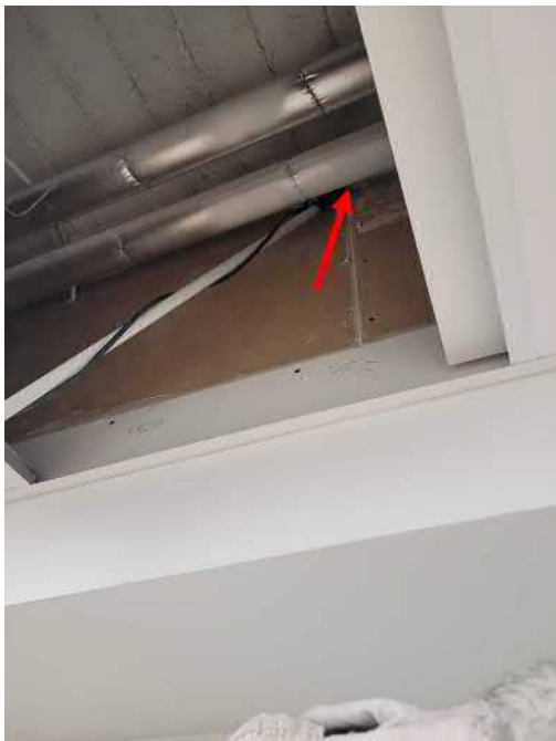
Kuva 26 Levytetty maanvastainen seinä vuotaa merkittävästi yläosasta
