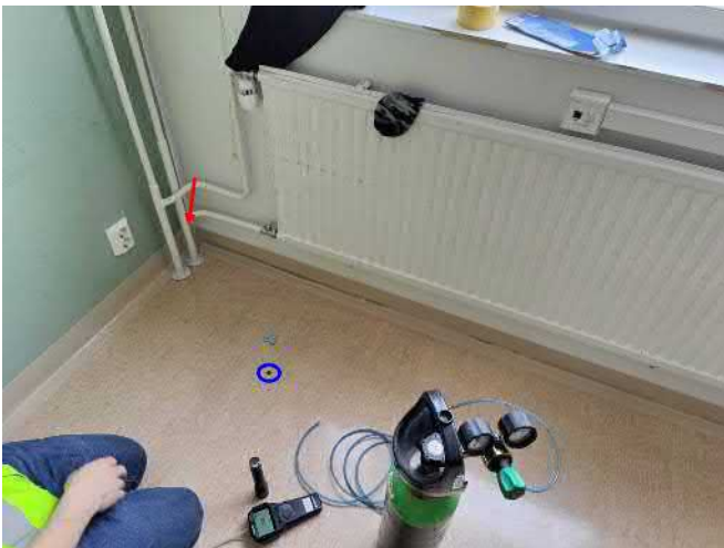
Kuva 60 Merkkiaineen syöttöpiste ulkoseinän vierustalla. Pistemäinen vuoto huoneen nurkassa ylösnostonnyläreunassa.
