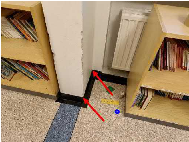
Kuva 48 Voimakas vuoto pilarin kohdalla, jalkalistan jatkos-/liitoskohdissa.
