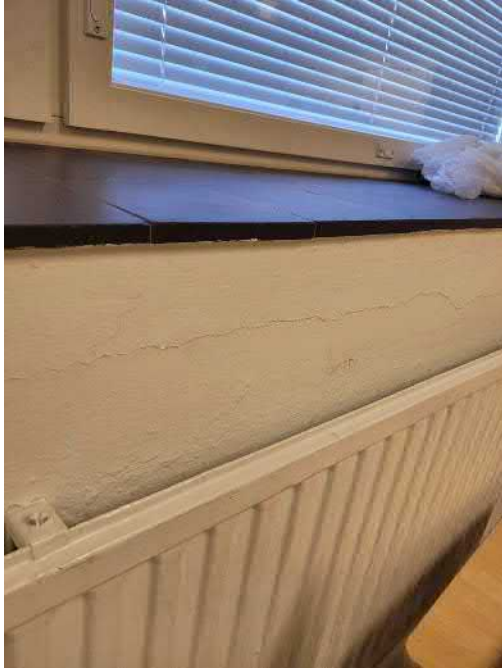
Kuva 14 Maanvastaisen seinän halkeamat vuotavat merkittävästi
