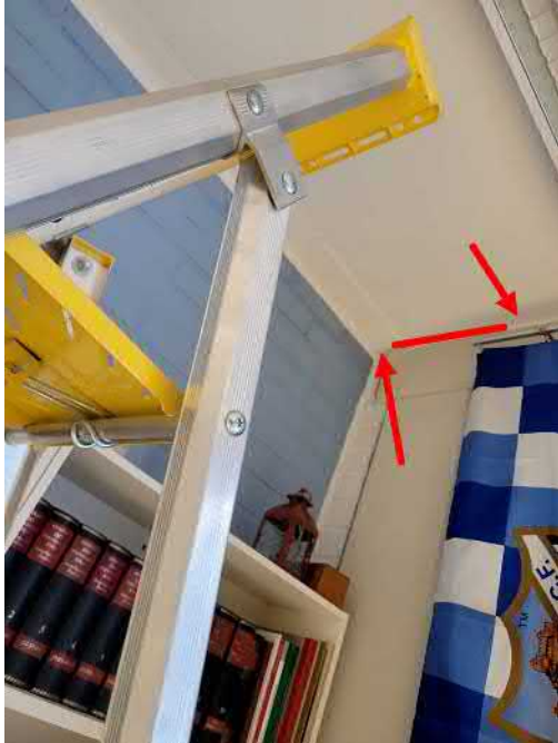
Kuva 46 Ulkoseinä ja yläpohja liittymä vuotaa merkittävästi.
