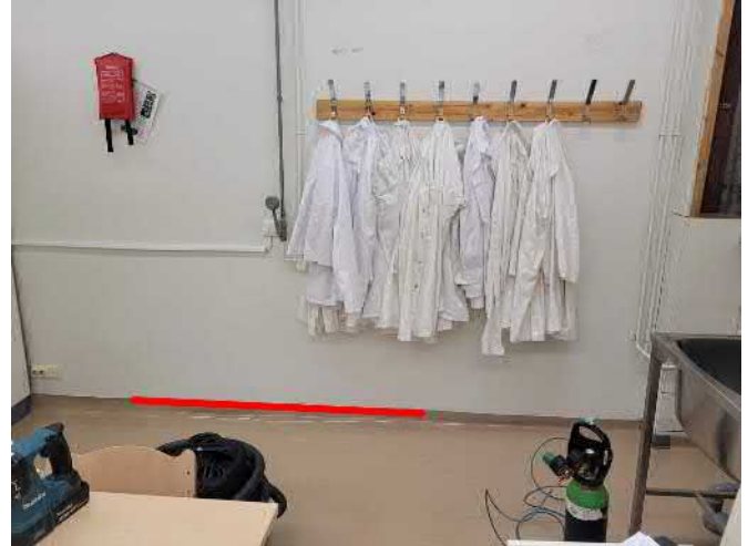
Kuva 39 Alapohja ja vanha US nykyinen VS liittymä vuotaa merkittävästi.
