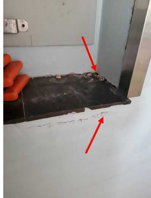
Kuva 17 Ikkunapenkit liittymät vuotavat merkittävästi
