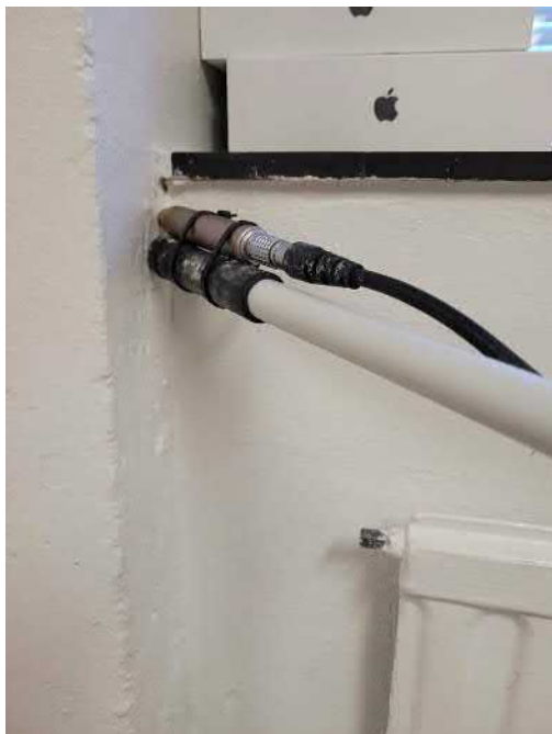
Kuva 12 MVS ja pilarin liittymä vuotaa vähäisesti.
