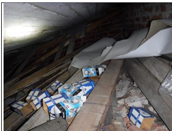
Roskaa ja lautoja ala-asteen (A2) erityisopetuksen siiven yläpohjassa
