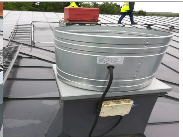
Puhallin katolla turvakytkimellä varustettuna
