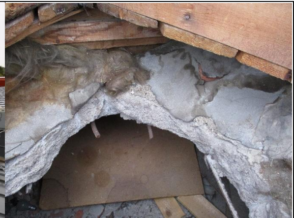
Ala-asteen (A2) vesikatto
