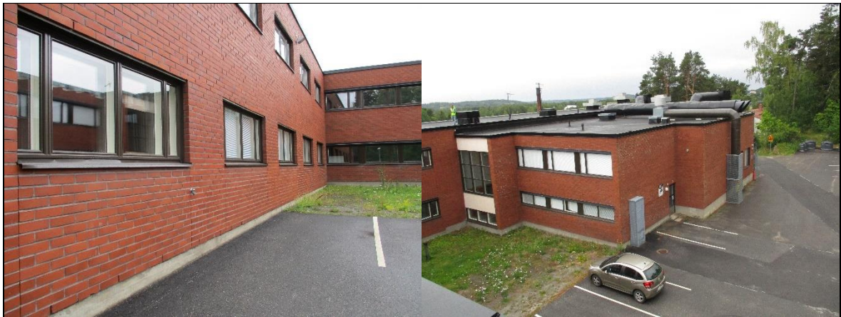
Ylästeen (B) maanpinnan kallistuksessa puutteita
