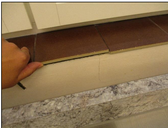
Irronneita ikkunalaattoja yläasteen (C) 1. kerroksessa
