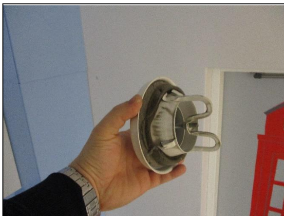
Kuva yläasteen luokkahuoneen Y233 poistoilmaventtiilistä
