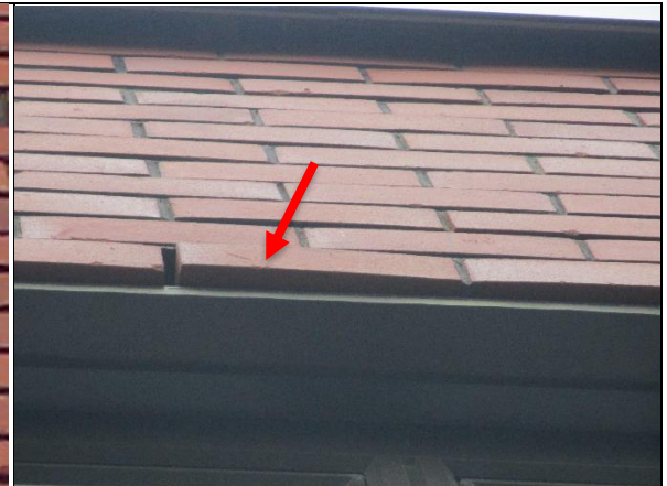
Ylä-asteen (C) julkisivun irtonainen tiili
