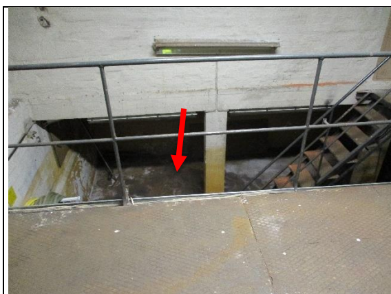
Ala-asteen (A1) kattilahuoneen mahdollinen öljyvuoto
