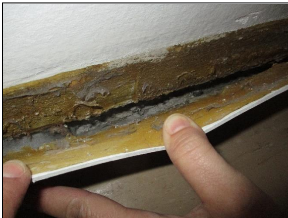
Lattian ja seinän liitoksen rako, yläaste (C) 1. kerros
