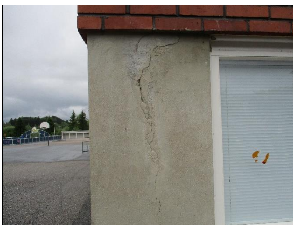
Ala-asteen (A1) halkeama seinässä
