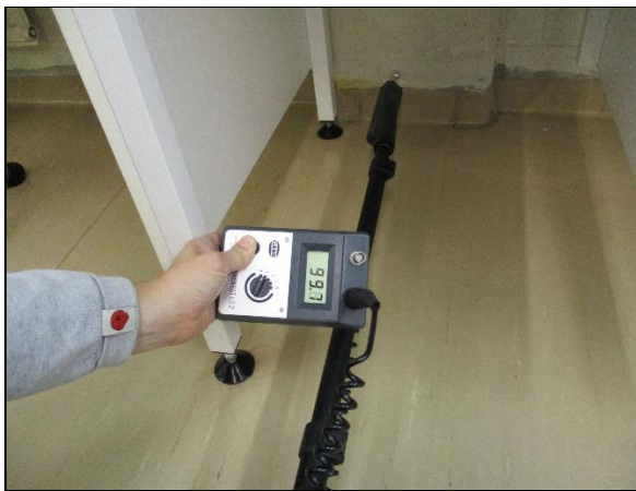
Yläasteen (C) 1. kerroksen pilarin juuressa pintakosteusmittarilla mitattaessa kohonnut kosteuskokema
