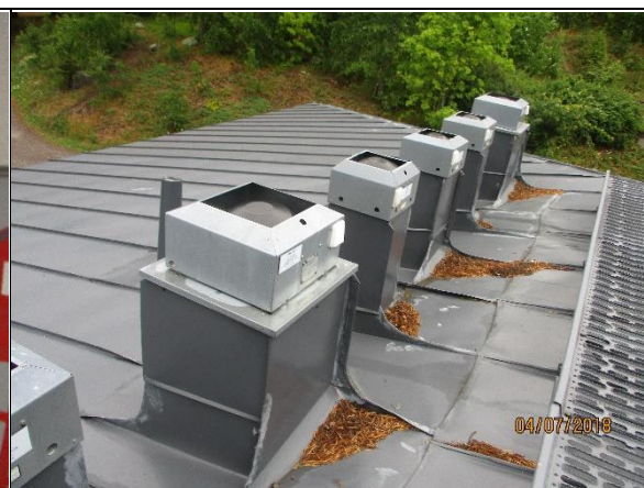
Huippumureita rakennusosan D vesikatolla
