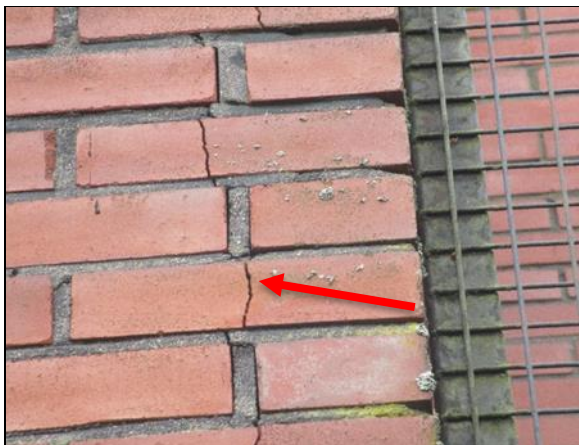
Ylä-asteen (B) tiilissä halkeamaa
