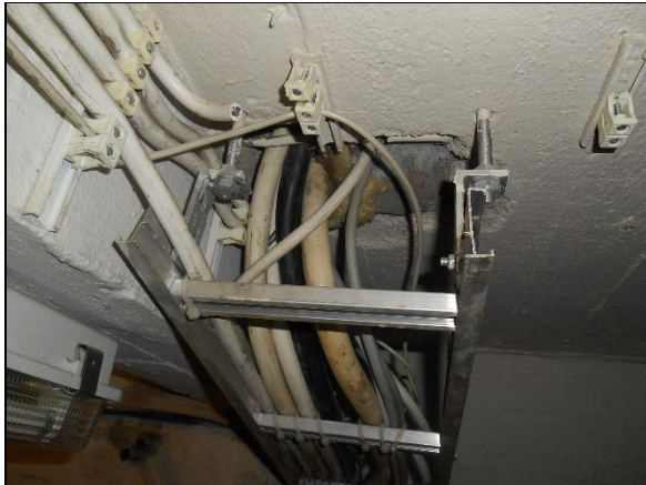
Läpivientejä kerrosten välissä.
