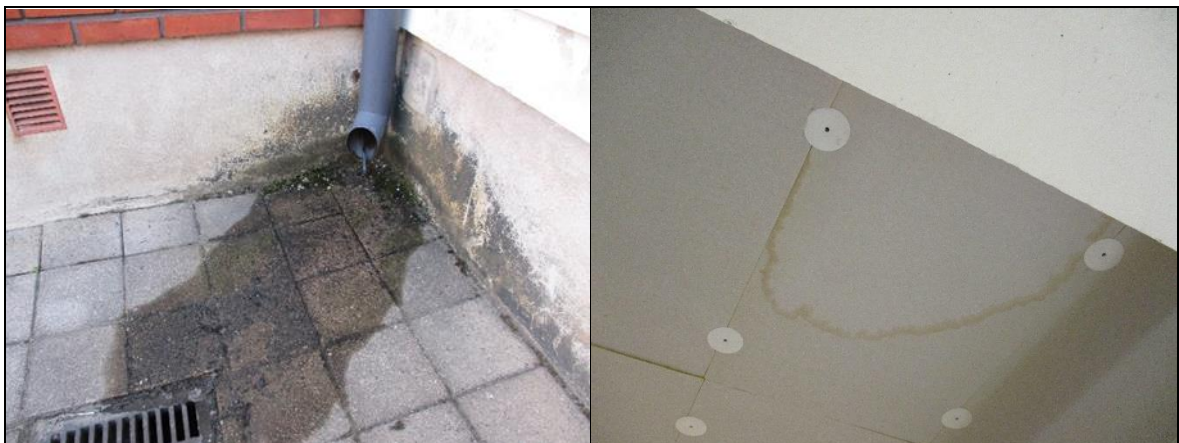
Ala-asteen (A1) seinän vierustan sadevesiä, sekä vuotojälkiä kellarikerroksen puutyöluokan käytävän akustiikkalevyssä
