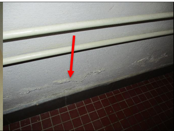
Ala-asteen (A1) lattian rajassa maalivauriota
