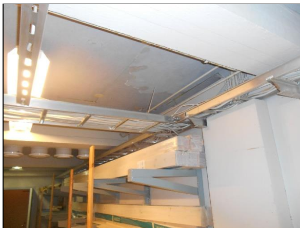
Vanhempia asennuksia (tikashylly ja valaistusripustus kisko)
