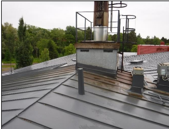
Ala-asteen (A1) vesikatto, ruostetta piipusta
