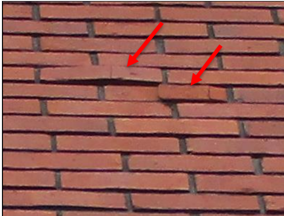
Ala-asteen (A1) julkisivun irtonaisia tiiliä
