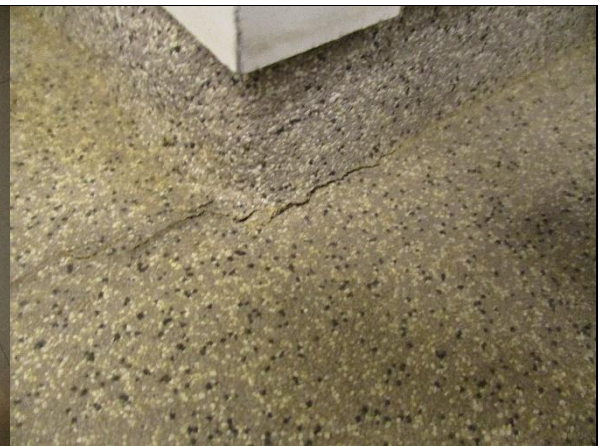
Halkeillut keittiön lattia yläasteen (B) vanhalla puolella
