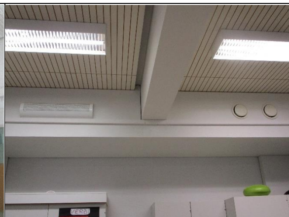
Ilmanvaihdon pääte-elimä yläasteen luokkahuoneessa
