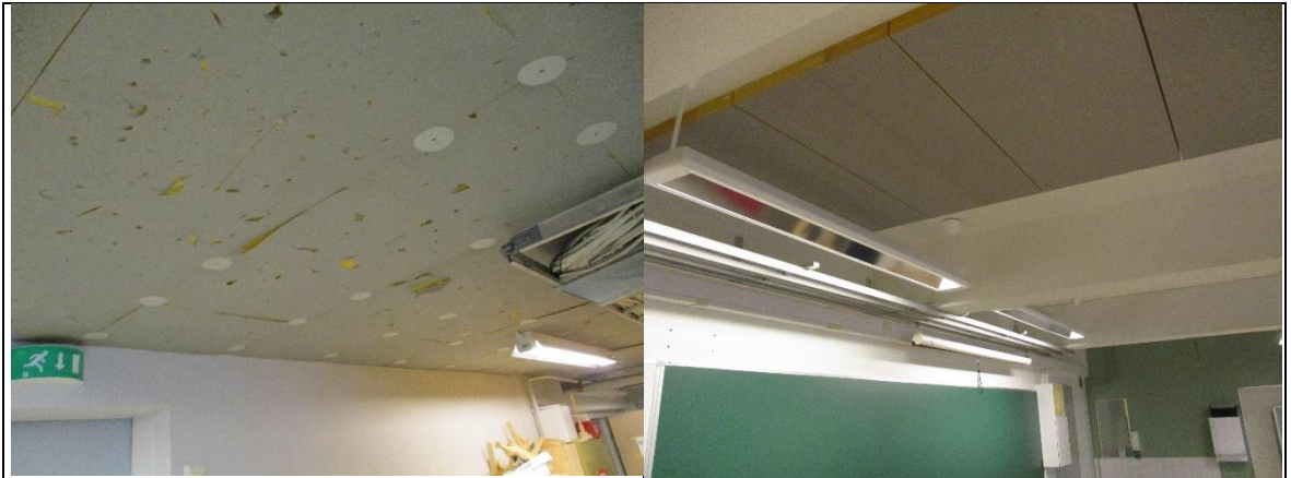
Vahingoittuneita akustiikkalevyjä ala-asteen (A1) puutyöluokassa
