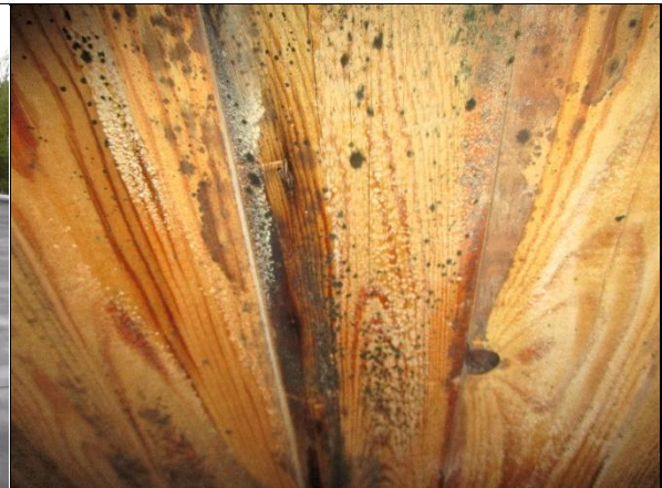
Yläasteen (B) yläpohjan puurakenteissa merkkejä kosteusvaurioista tai tuuletuksen puutteesta
