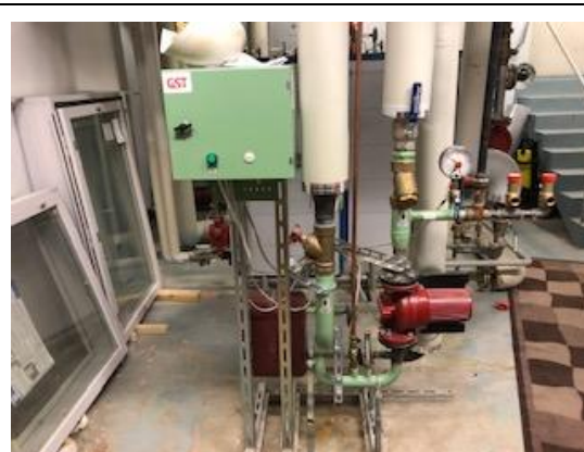
Ilmanvaihdon lämmönvaihdin vuodelta 2005.
