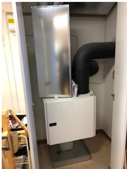
Tallikoulun tulo- ja poistoilmanvaihtokoje.
