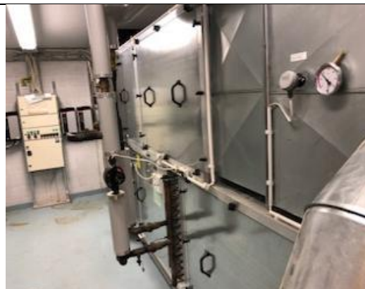
Kivikoulun tulo- ja poistoilmanvaihtokoje.
