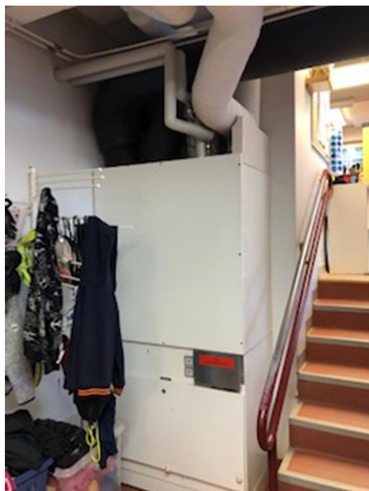
Kivikoulun tulo- ja poistoilmanvaihtokoje.
