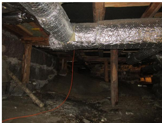
Puukoulun ryömintätilan maapohjassa havaittiin kosteutta.
