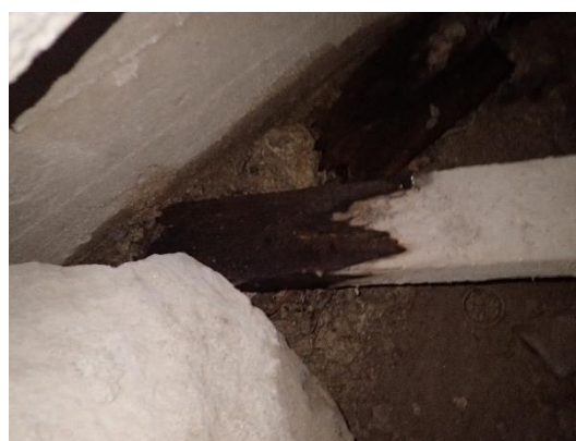
Ryömintätilassa on kosteusvaurioitunutta puumateriaalia.
