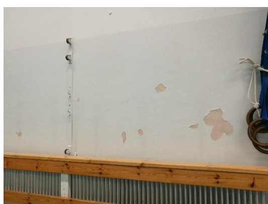
Liikuntasalin seininen maalipinnoite hilseilee.
