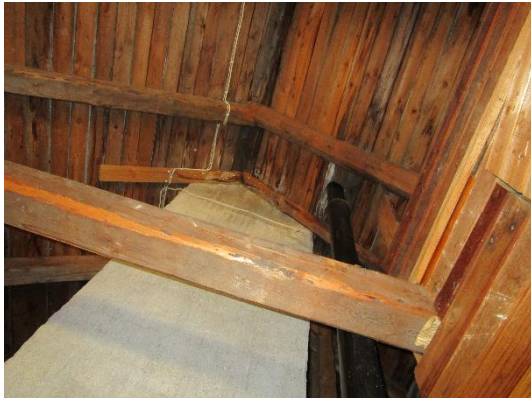
Puukoulun kylmässä yläpohjassa vesivuotojälkiä.
