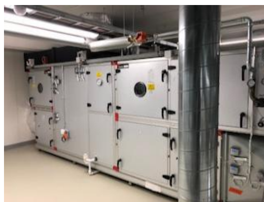
Kivikoulun tulo- ja poistoilmanvaihtokoje.
