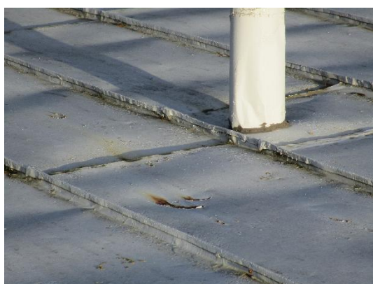
Kivikoulun alkuperäisessä katteessa havaittavissa alkavaa ruostumista.
