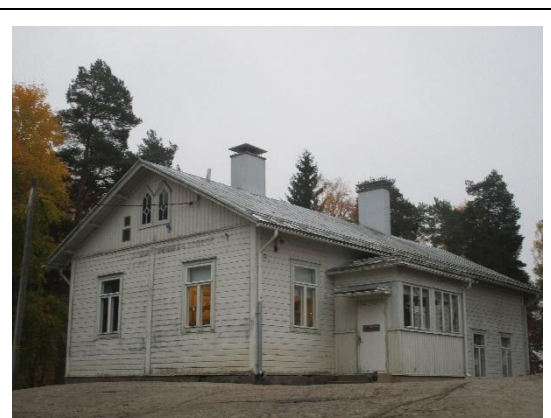
Tallikoulun ulkoverhouksen maalipinnoite hilseilee.
