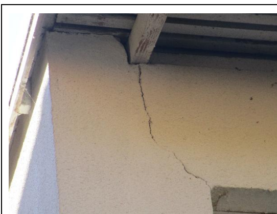
Kivikoulun julkisivussa vähäistä halkeilua.
