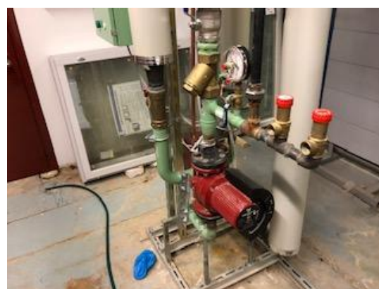
Ilmanvaihdon lämmityksen vaihdin vuodelta 2005, varoventtiilit putkittamatta.
