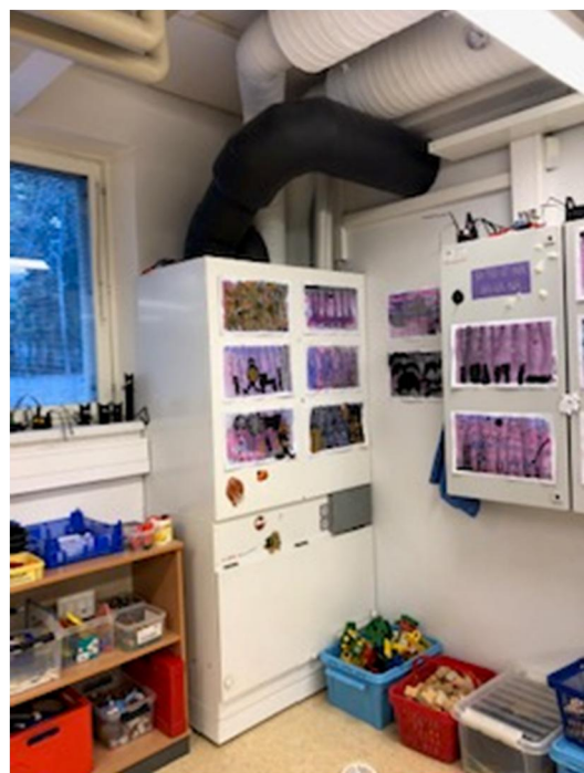
Kivikoulun tulo- ja poistoilmanvaihtokoje.
