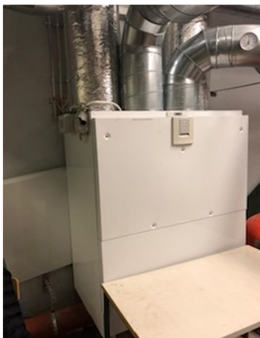
Ryömintätilan tulo- ja poistoilmanvaihtokoje.
