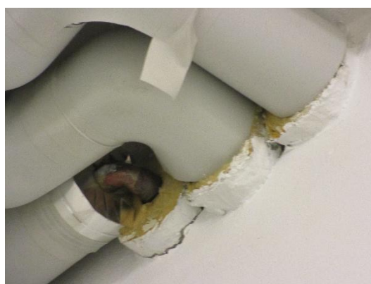
Keittiössä putkieristeiden villoja näkyvissä.
