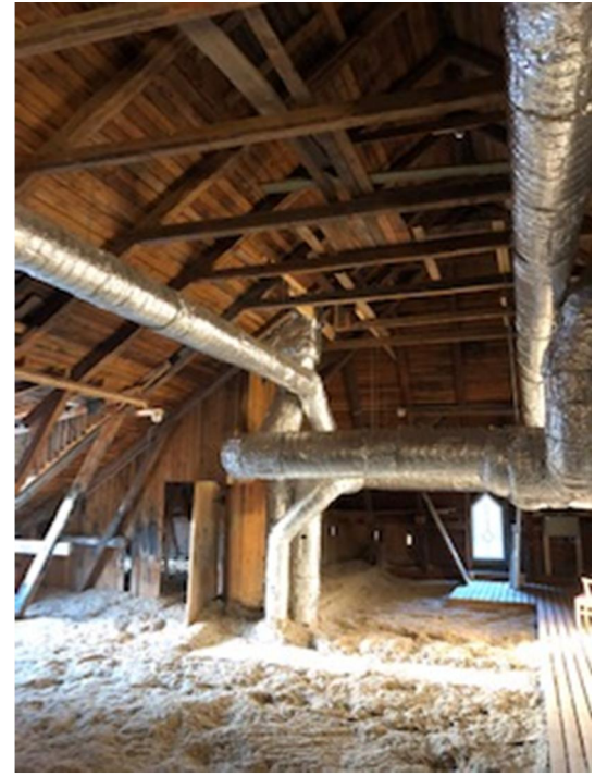
Puukoulun yläpohjan IV-kanavia.
