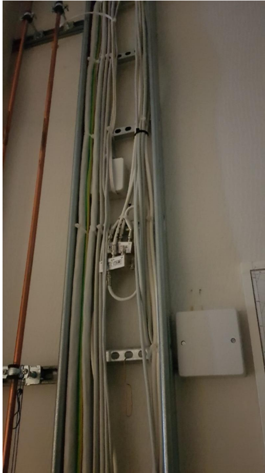
Puukoulun antenniasennukset kiinnittämättä.
