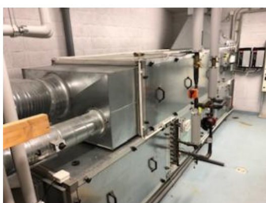
Kivikoulun tulo- ja poistoilmanvaihtokoje.
