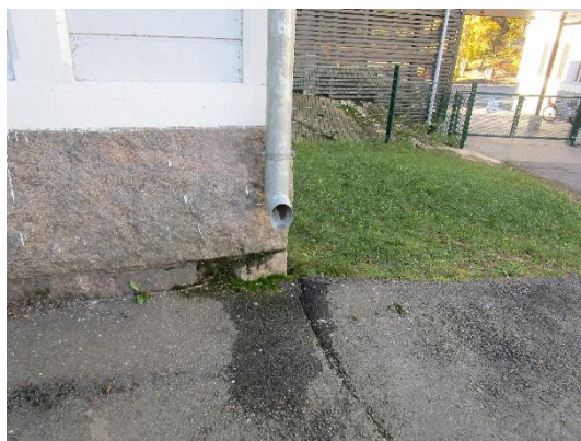
Puukoulun kattovesien ohjaus.
