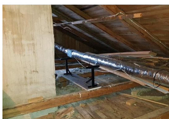
Ullakon uudet asennukset kiinnittämättä.
