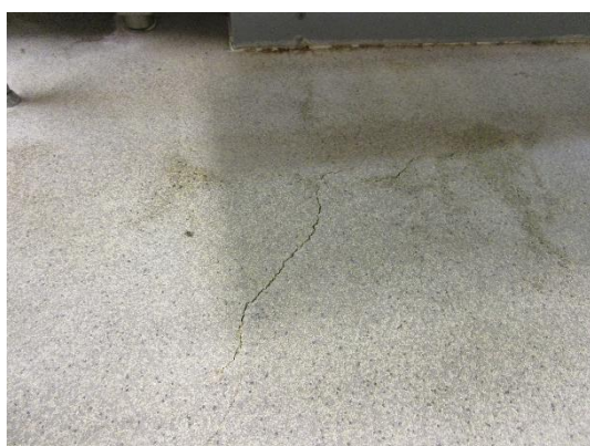
Keittiön lattiapinnoitteessa on halkeama.
