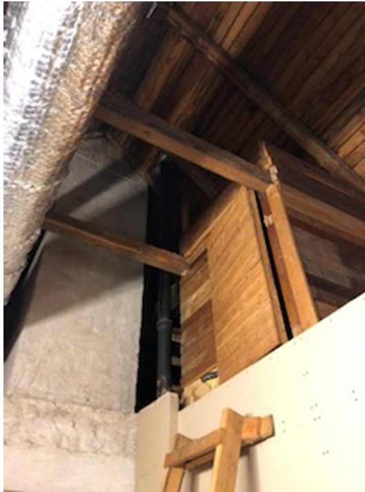
Puukoulun yläpohjan IV-kanavia.
