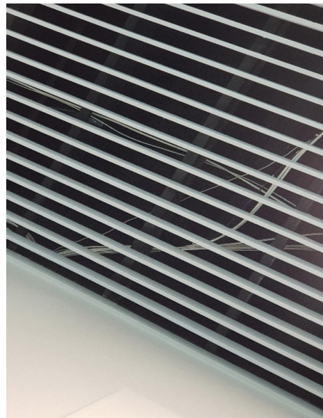
Kaapeli-asennukset liikuntasalissa vapaasti ritiläkaton yläpuolella.
