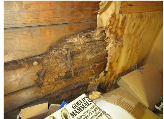
Puukoulun vinttikomeron ulkoseinällä laho- vaurioita.
