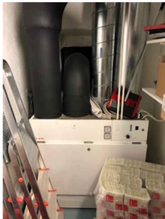
Puukoulun tulo- ja poistoilmanvaihtokoje.
