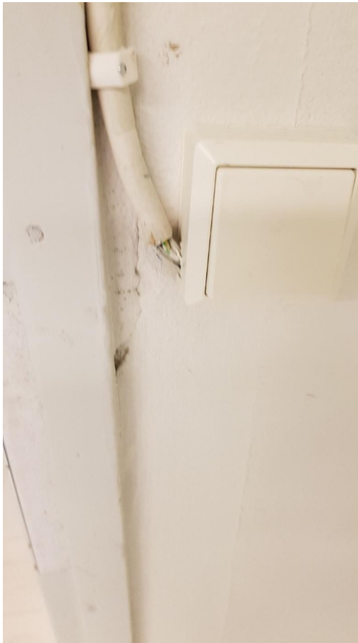
Kivikoulun valaisinkytkimen kaapeli vaurioitunut.
