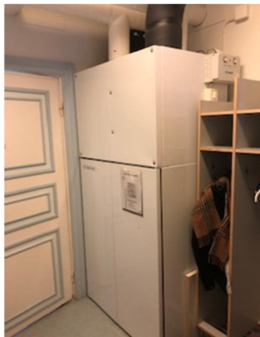
Tallikoulun tulo- ja poistoilmanvaihtokoje.
