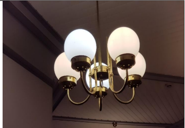
Puurakennuksen valaisimissa vaihteleva värilämpötila.
