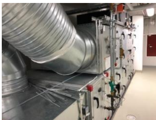
Kivikoulun tulo- ja poistoilmanvaihtokoje.
