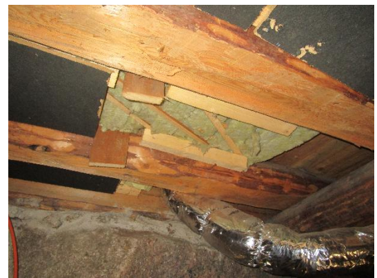
Puukoulun alapohjaa on lisälämmöneristetty. Asennukset ovat puutteellisia.
