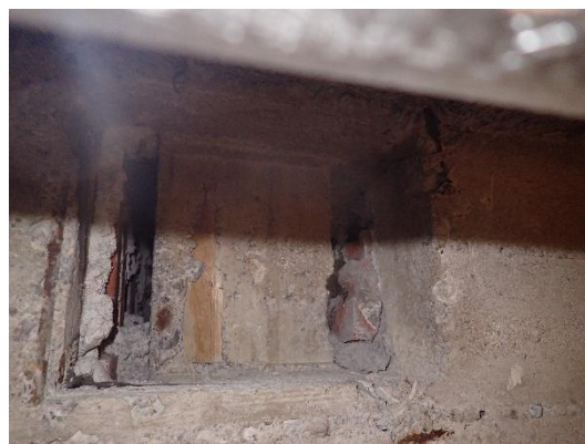
Putkikanaalissa on tiivistämättömiä läpivientejä.
