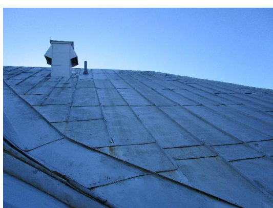
Puukoulun peltikatteen maalaus irtoaa
