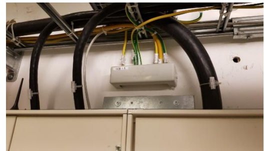
Lisätty maadoituskisko SEB 1.1, PK-huoneessa.
