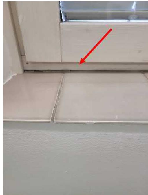
Kuva 8 Näkyvät raot ikkunan alaosissa. Merkittävää ilmavuotoa havaittiin ko. kohdissa.
