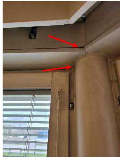
Kuva 16 Ikkunan yläpuoleinen levyrakenne vuotaa.
