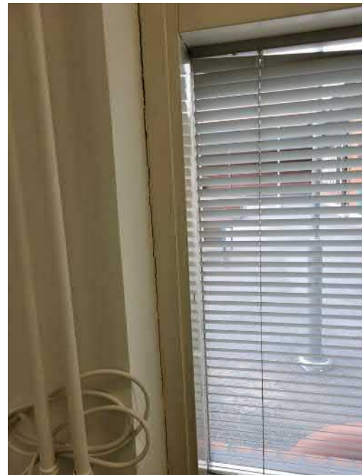
Kuva 2 Ikkunan sivuosassa selvä rako
