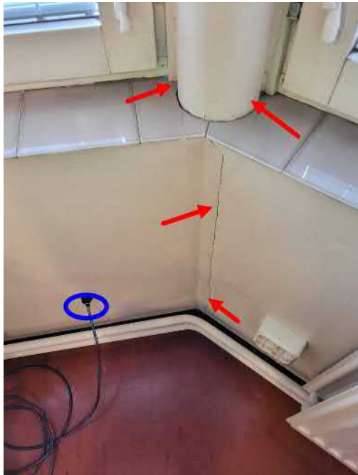
Kuva 15 Ikkunan pilariliittymät vuotavat ja seinän alaosan halkeama
