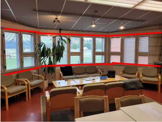
Kuva 13 Ikkunaliittymät vuotavat (Kts. pohjakuvan 1, Mustavalkoinen merkintä 13.)
