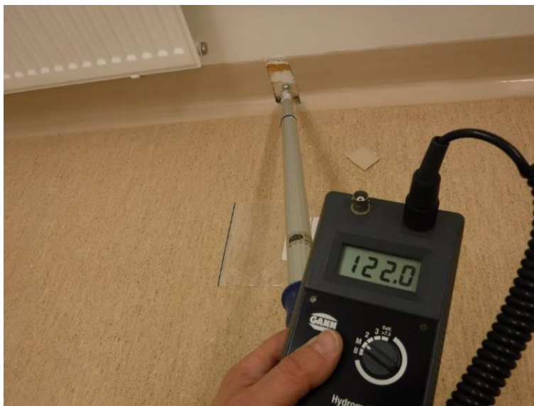
Kuva 2. Pintakosteusilmaisimella havaittiin jalkalistan takaa kohonneita kosteuslukemia jokaisessa mikrobinäytteenottokohdassa.
