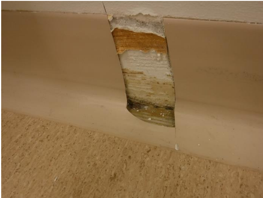
Kuva 5. Muoviset jalkalistat ovat mikrobivaurioituneet maasta kapillaarisesti nousevan kosteuden vaikutuksesta.
