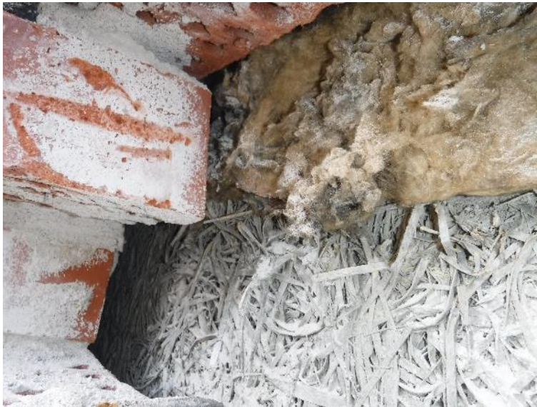
Kuva 10. Rakenneavaus nro 5. Avauskohdassa ulkoseinän lämmöneriste muuttuu tojalevystä mineraalivillaksi.
