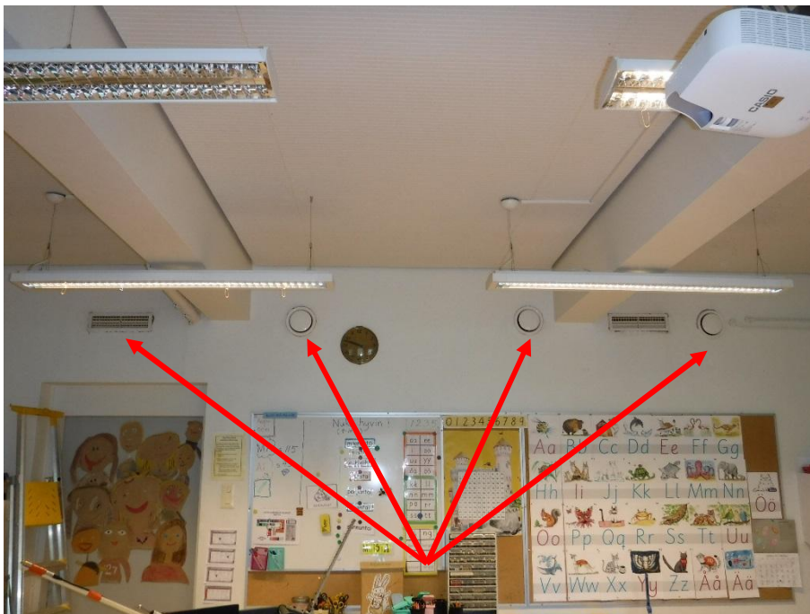
Kuva 27. Tulo- ja poistoilmanvaihdon päätelaitteet sijaitsevat vierekkäin väliseinän yläosassa.
