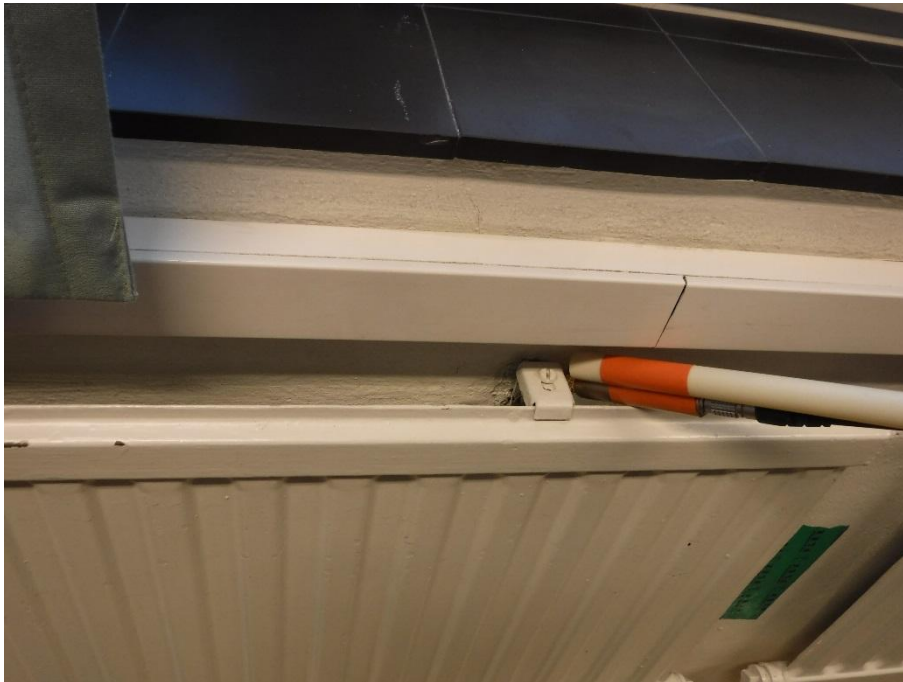
Kuva 22. Merkkiainekokeella havaittiin ilmavuotoa pattereiden kiinnityskohtien kautta.
