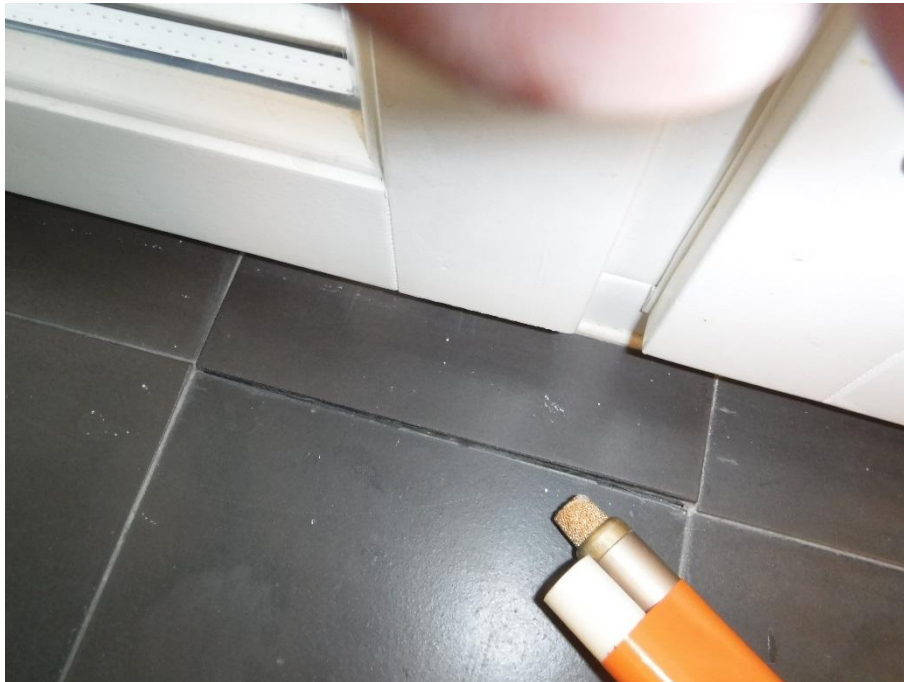
Kuva 20. Merkkiainekokeella havaittiin ilmavuotoa ikkunapenkkien laattasaumojen kautta.
