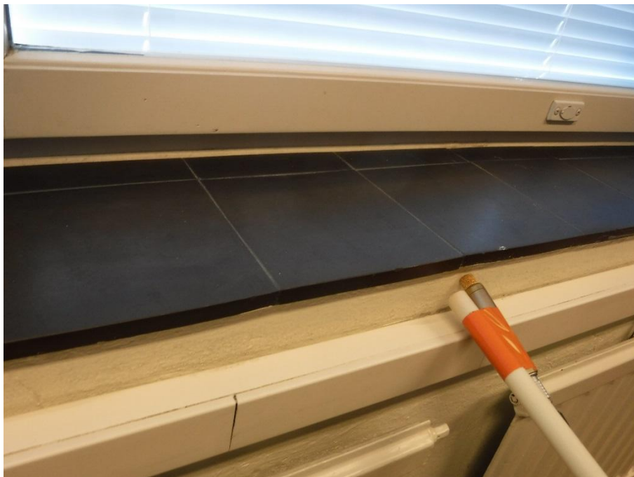
Kuva 21. Merkkiainekokeella havaittiin ilmavuotoa ikkunapenkin ja ulkoseinän liitoskohdasta.
