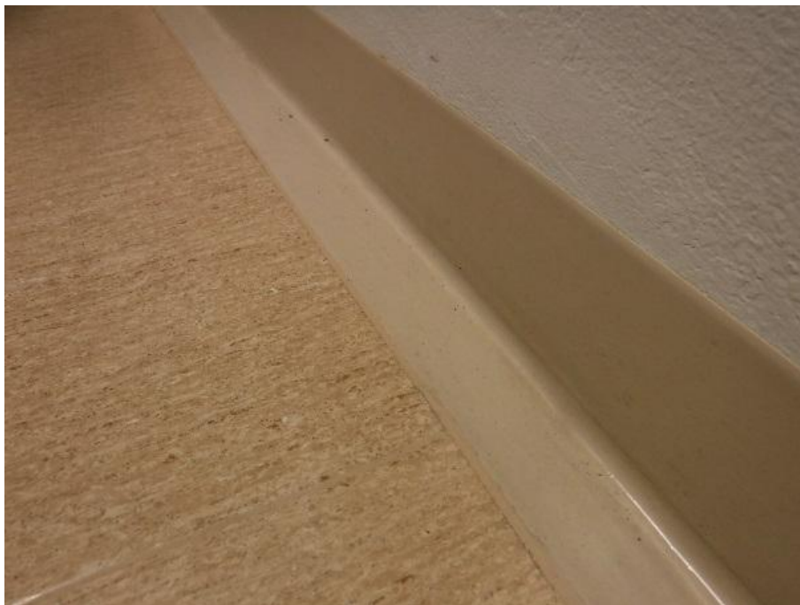
Kuva 19. Merkkiainekokeella havaittiin ilmavuotoa muovisten jalkalistojen takaa.
