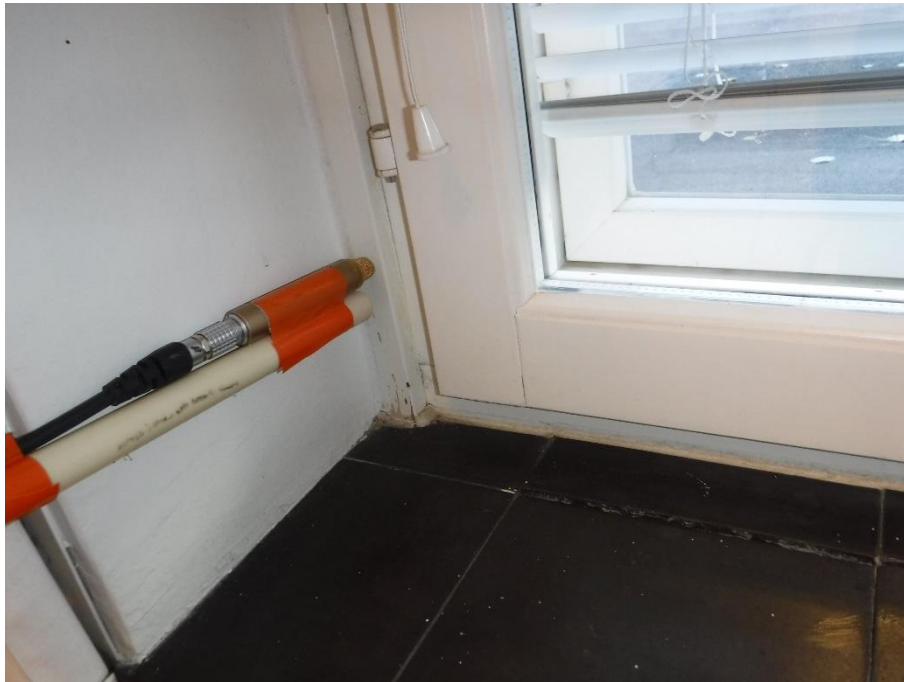
Kuva 18. Merkkiainekokeella havaittiin ilmavuotoa ikkunaliittymien kautta.
