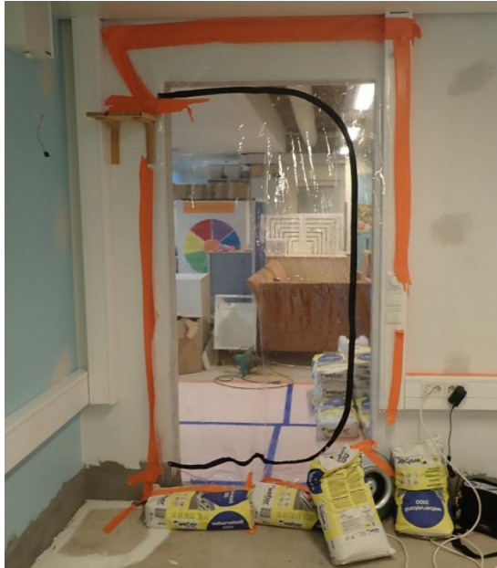
Kuva 1. Alipaineistin ja sulkuovi toiminnassa luokan 115 oviaukossa 12.7.2019
