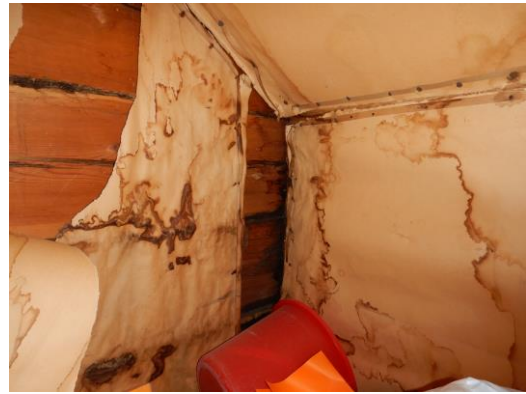
Kuva 24 Vuotojälkiä kattolyhdyn kohdalla komerossa.
