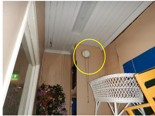
Kuva 28 Korvausilmaventtiili hormiin talomiehen asunnon vanhassa keittiössä.
