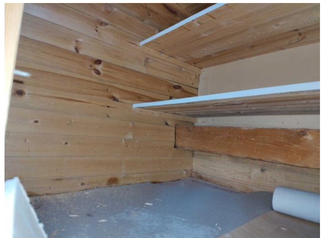
Kuva 20. Komerosta on ilmayhteys ulkoseinärakenteeseen ja välipohjarakenteeseen.
