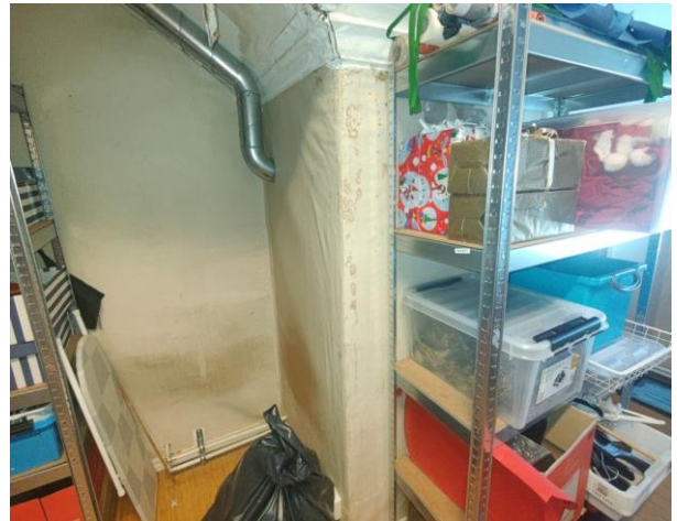
Kuva 18. Pinkopahvit ovat kosteusvaurioituneet.
