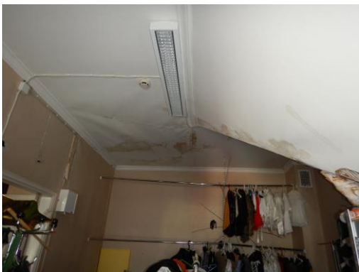
Kuva 21 Vuotojälkiä sisäkatossa talonmiehen asunnossa.
