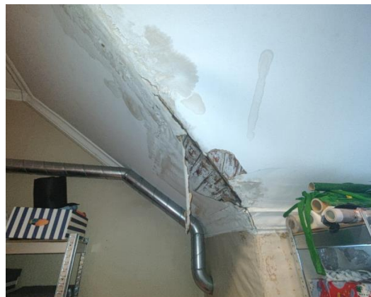
Kuva 22 Vuotojälkiä kattolyhdyn kohdalla.
