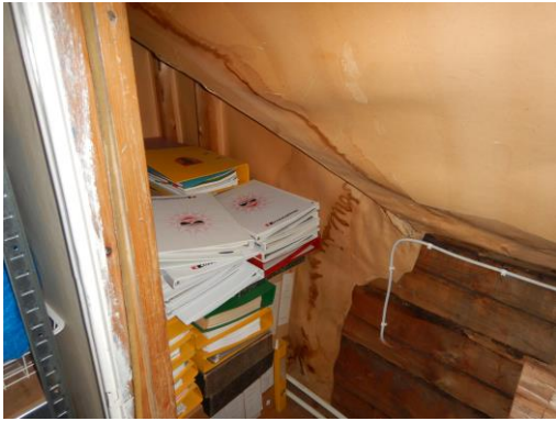
Kuva 23 Vuotojälkiä komeron pinkopahvissa talomiehen asunnossa.
