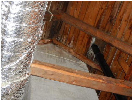
Kuva 25. Vuotojälkiä hormin ja vesikaton liitoskohdassa.
