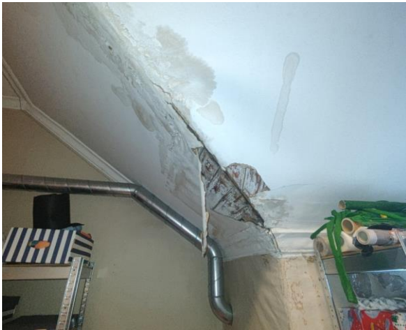
Kuva 17. Vesikarrovuodot ovat kasteleet väliseiniä.
