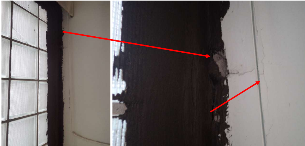
Kuvat 9-10. Päätyulkoseinässä havaittiin ikkunan ja ulkoseinän tiivistyksen rajapinnassa koloja ja kauempana liittymästä seinässä halkeamia, joista todettiin ilmavuotoa.
