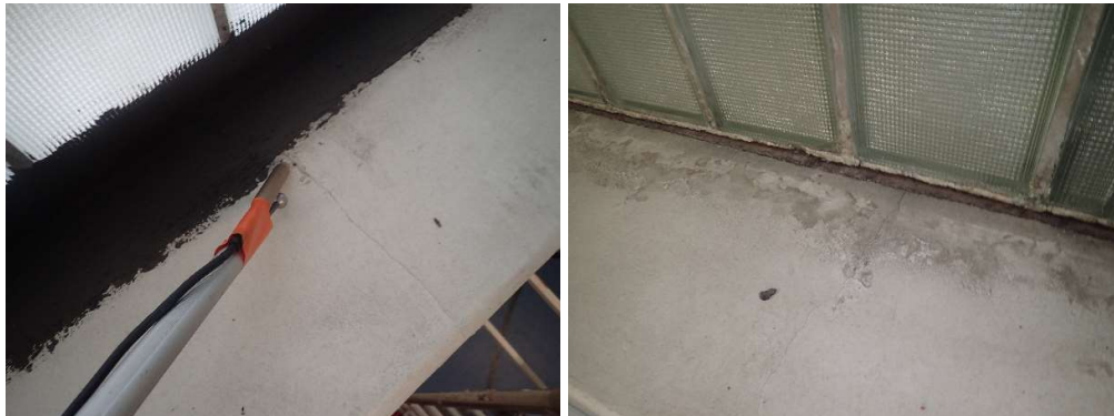
Kuvat 11-12. Ikkunapenkin halkeamista sekä keittiön ja liikuntasalin välisen seinän ja ikkuna liittymistä havaittiin ilmavuotoa. Ikkunoiden metallisissa alapuitteissa havaittiin ruostetta ja ikkunapenkissä maalin irtoilua.
