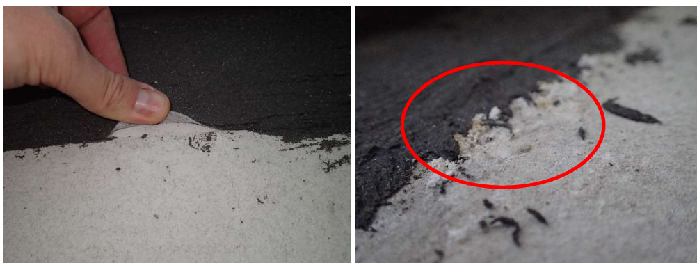
Kuvat 13-14. Ikkunapenkissä tiivistysnauha oli paikoin reunoilta irti alustasta. Ikkunapenkissä havaittiin paikoin koholla olevia pintakosteusilmmaisimen lukemia ja kalkkihärmettä.
