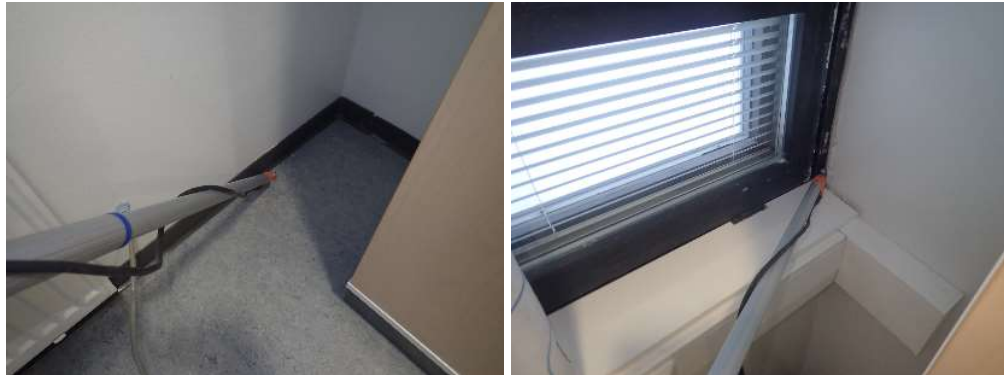
Kuvat 8 ja 9. Ilmavuotoja havaittiin jalkalistan takaa sekä ikkunan ja ulkoseinän liittymistä.
