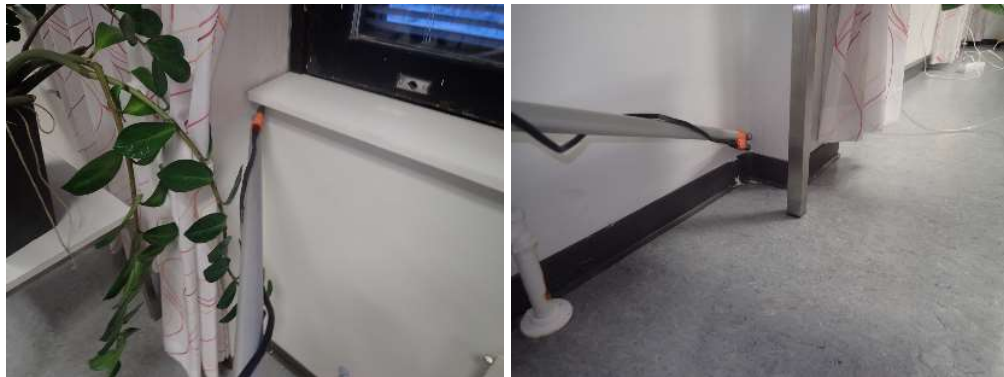
Kuvat 10 ja 11. Ilmavuotoja ikkunanpenkin ja ulkoseinän liittymistä (kuva 10) sekä jalkalistan takaa betonipilarien kohdalla (kuva 11).
